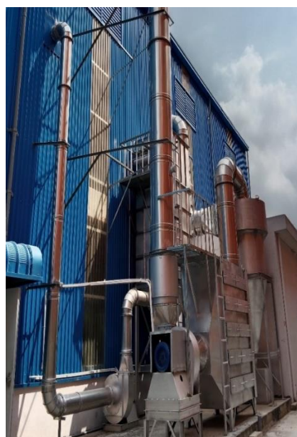
b. Hình ảnh đường ống nhánh, ống chính
