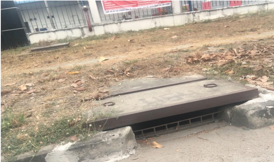
Hình 3.3. Hồ ga thoát nước mưa KCN trước công nhà máy
