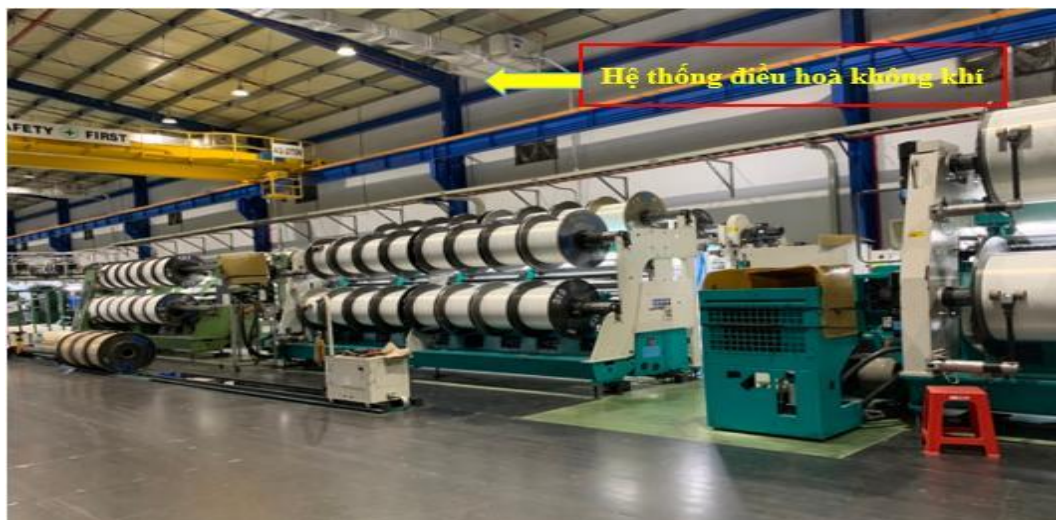
Hình 3.13. Hiện trạng hệ thống điều hòa không khí trong xưởng 2
