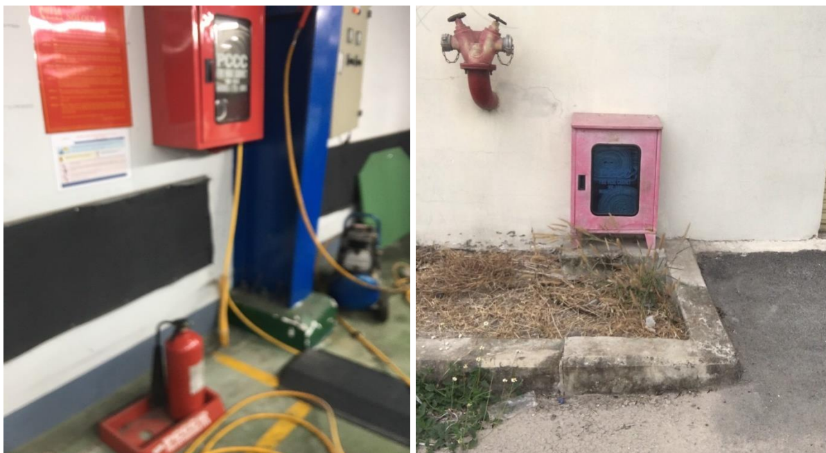
Hình 3.12. Một số hình ảnh hệ thống PCCC tại cơ sở
