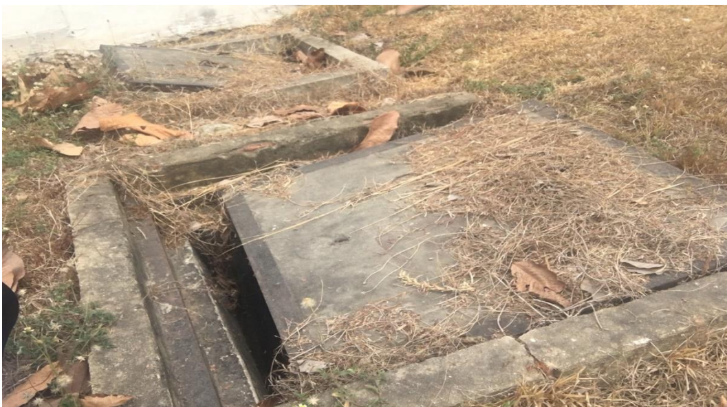
Hình 3.6. Hố ga 131 đầu nối thoát nước thải KCN
