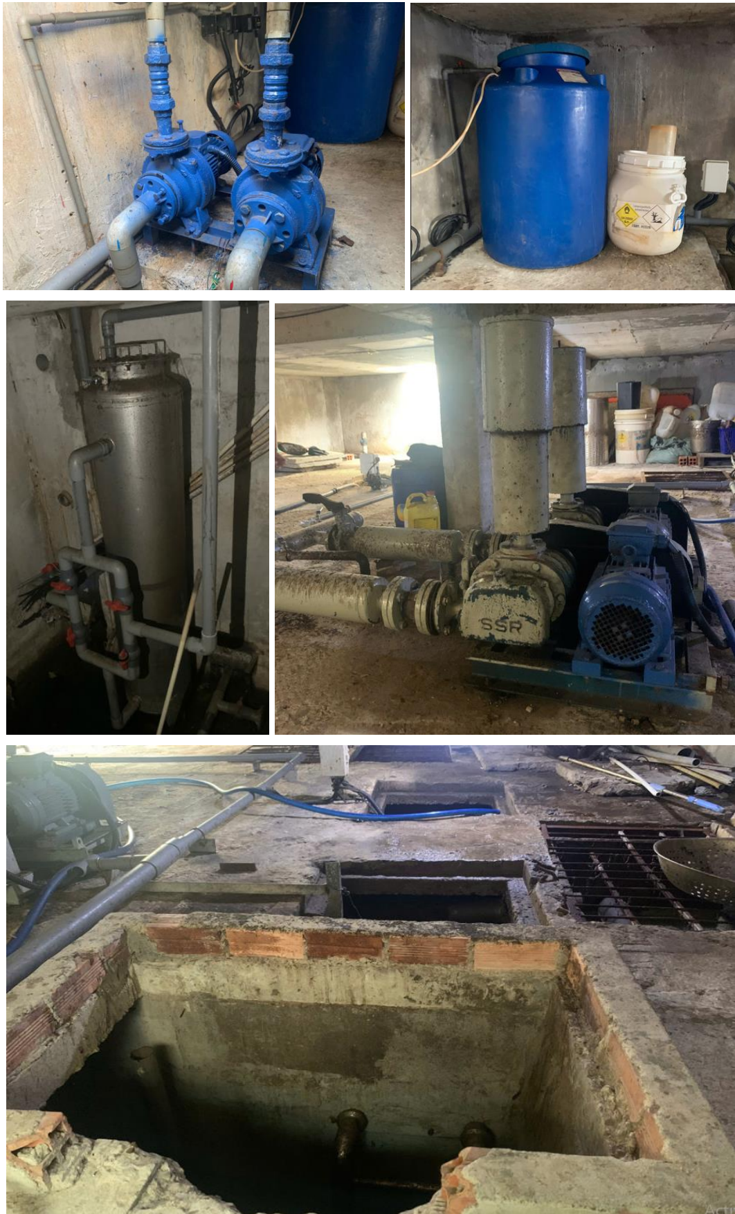
Hình 3.5: Một số hình ảnh tại hệ thống xử lý nước thải công suất 40 m 3 /ngày.đêm
