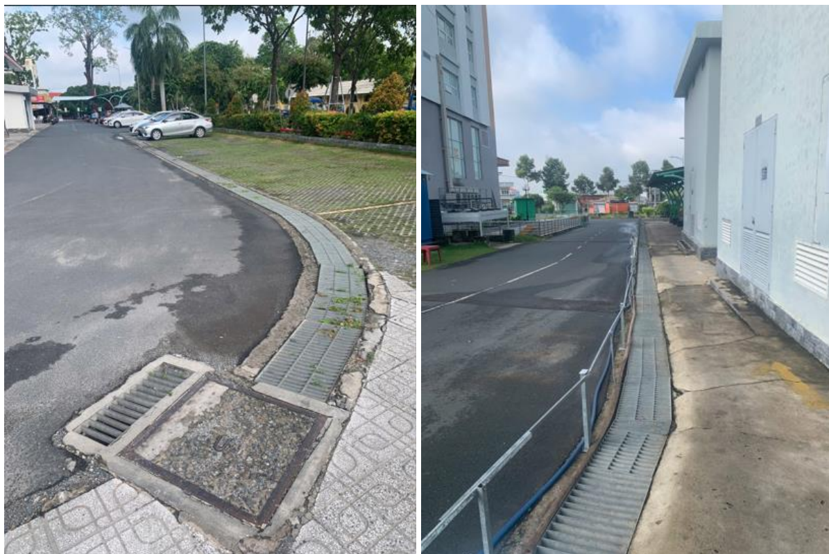
Hình 3.1: Hố ga và mương hở thu gom nước mưa
