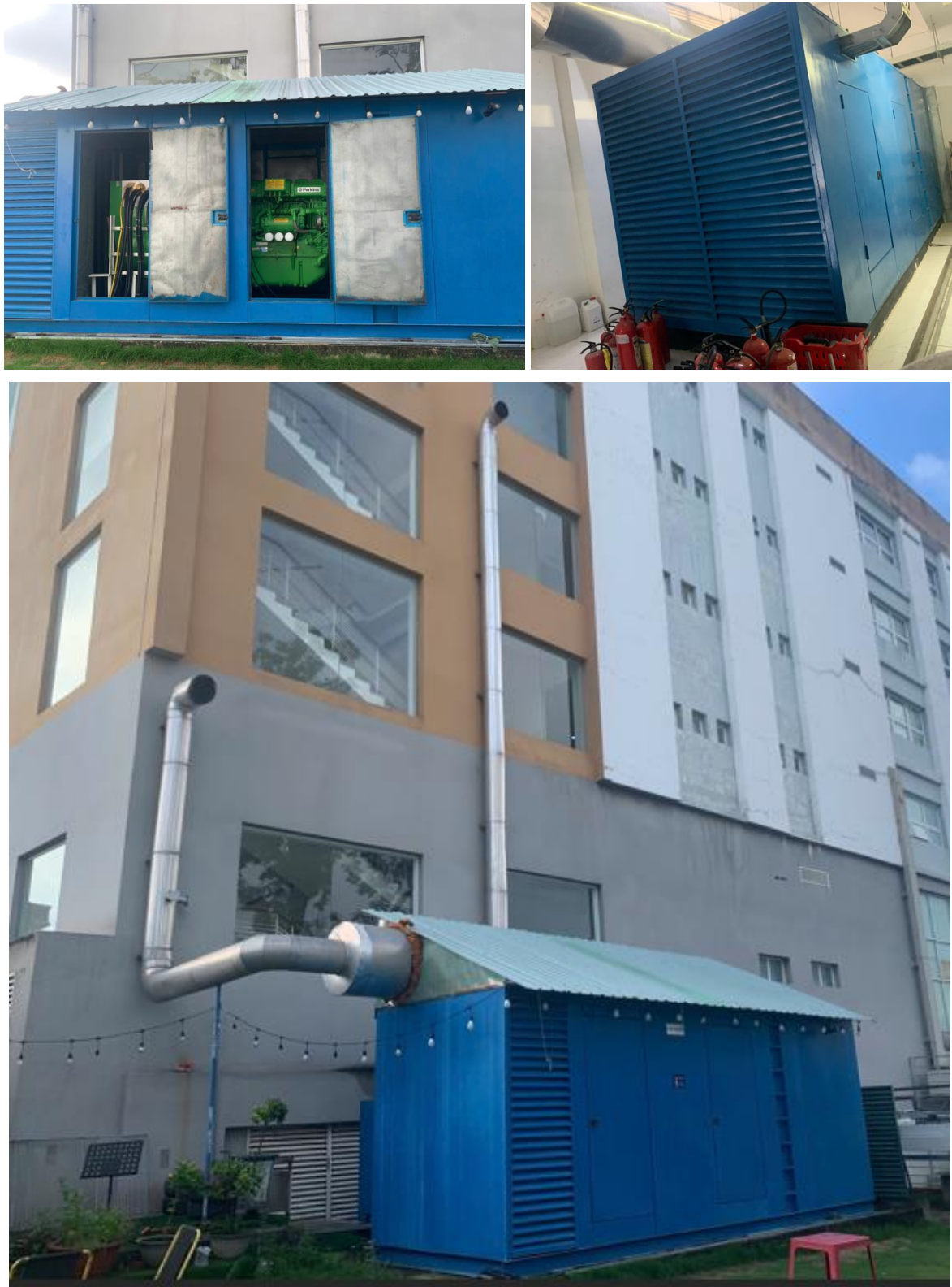
Hình 3.6: 02 máy phát điện dự phòng và ống khói
