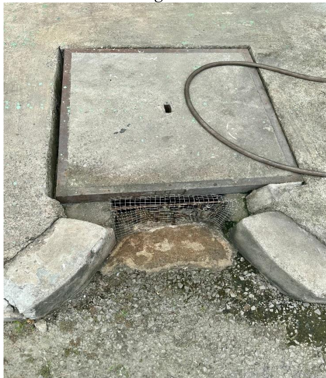
Hình 3.2 Hố ga thu gom nước mưa
