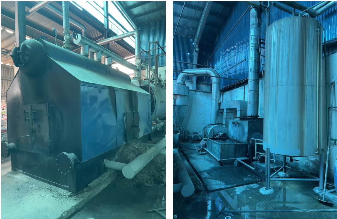
Hình 12. Khu vực lò hơi và hệ thống xử lý khí thải lò hơi tại Nhà máy
