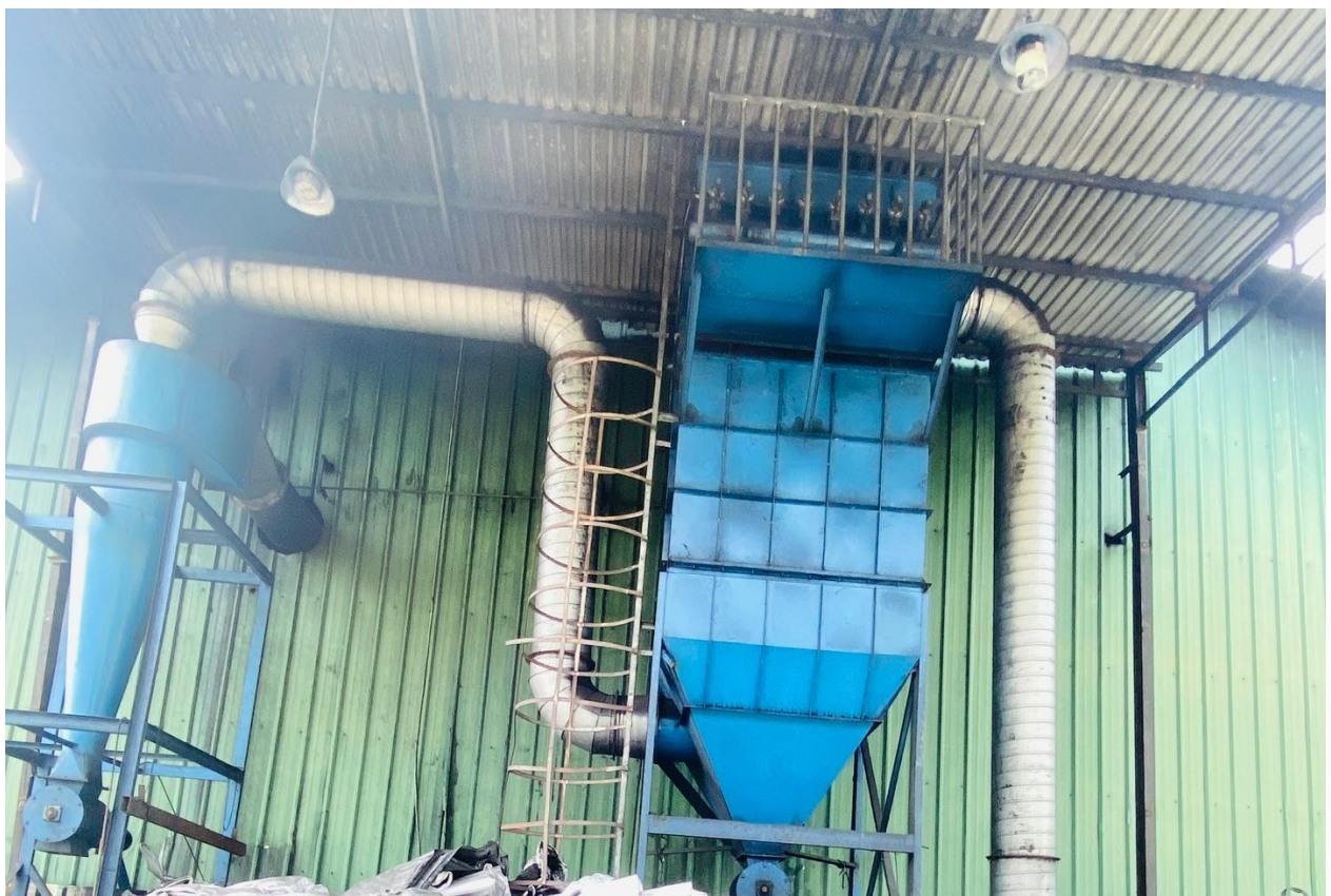
Hình 3.13. Hình ảnh hệ thống thu hồi bụi than bên trong nhà xưởng sản xuất
