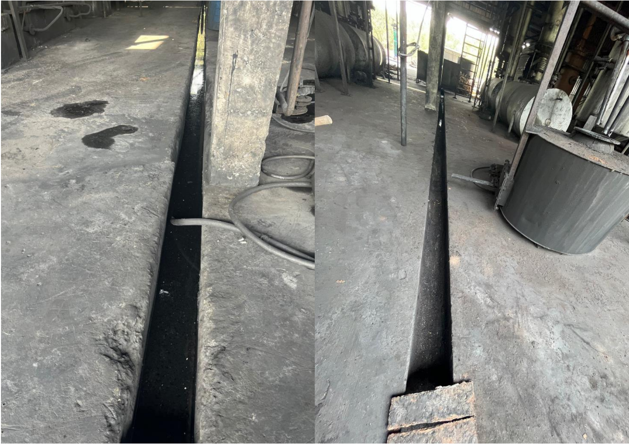
Hình 3.3. Hình ảnh đường thu gom nước thải của Nhà máy
