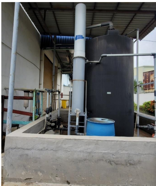
Hình 3.7: Khu vực bồn chứa HCl và hệ thống xử lý hơi HCl tại cơ sở
