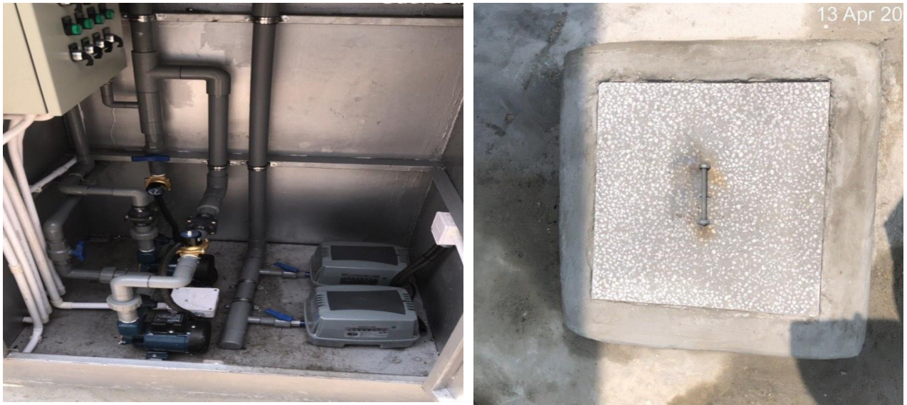
Hình 3.6 Hệ thống xử lý nước thải, công suất 5 m 3 /ngày.đêm
