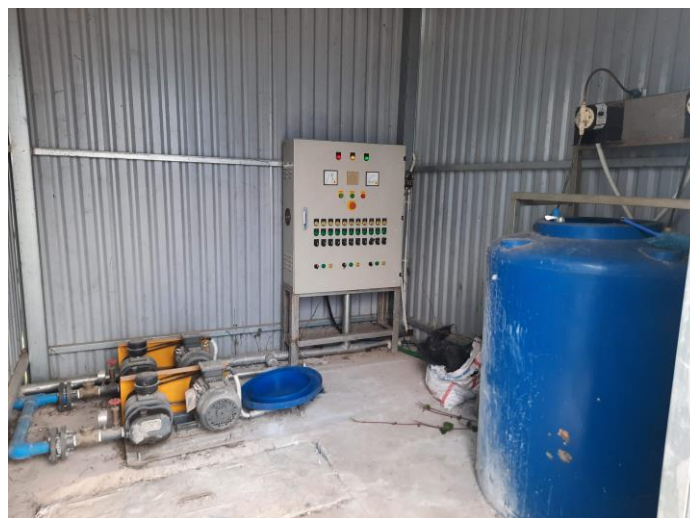
Hình 3. 6: Hệ thống xử lý nước thải tại cơ sở
