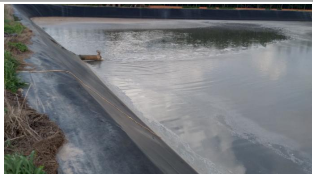
Bể điều hoà
