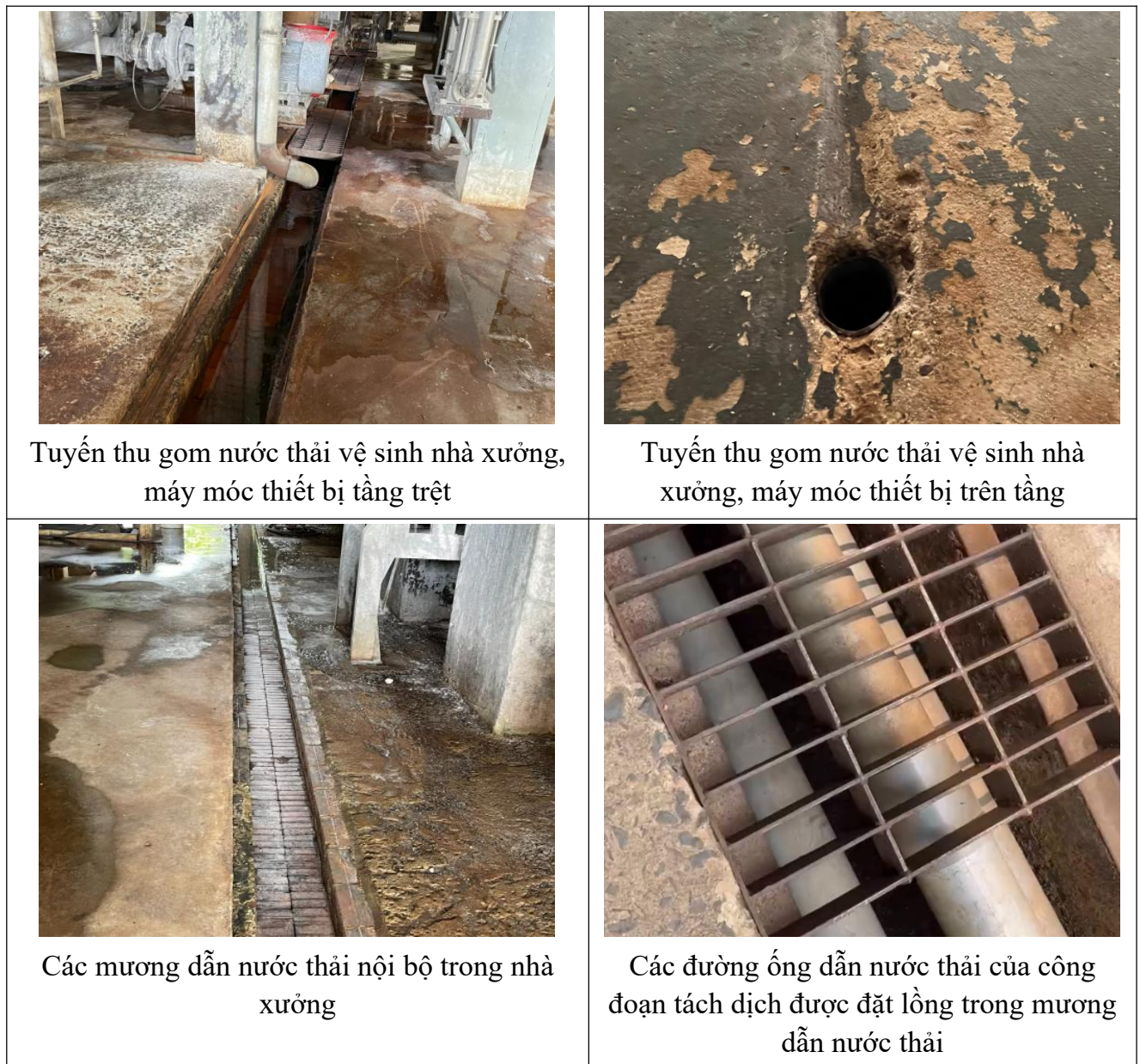
Hình 3.4. Một vài hình ảnh công trình thu gom, thoát nước thải tại Nhà máy
