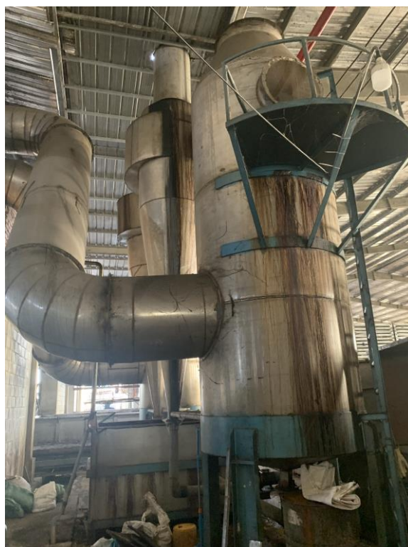
Hình 3.9: Tháp khử mùi
