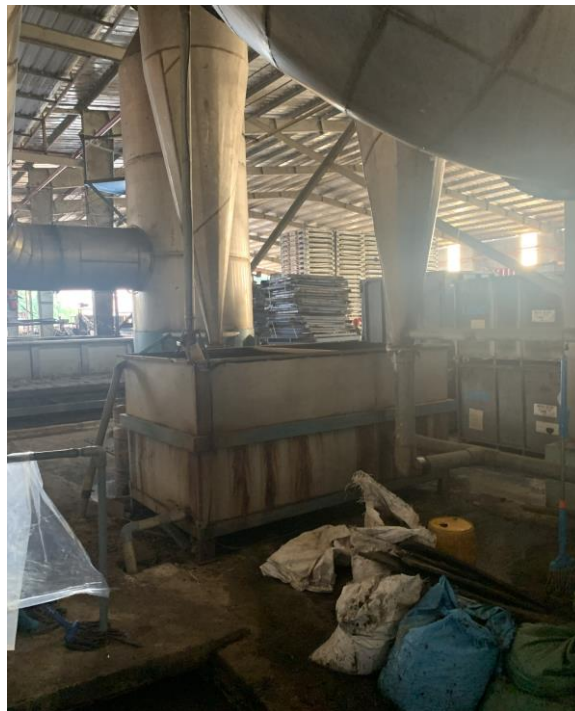
Hình 3.4: Đường ống xả đáy bể chứa dung dịch hấp thụ của tháp khử mùi
