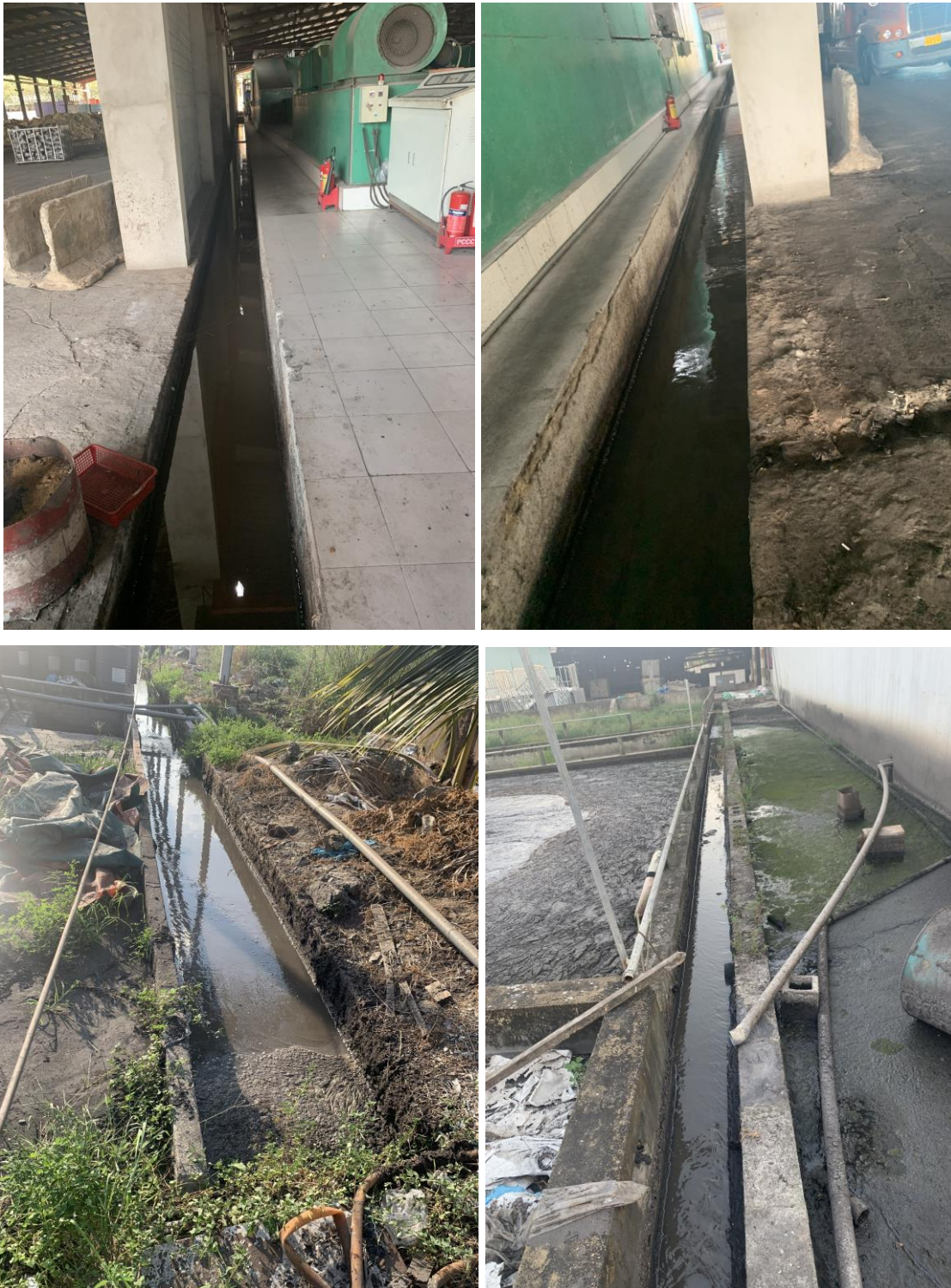
Hình 3.5: Mương dẫn nước thải chính đưa về bể gạn mủ
