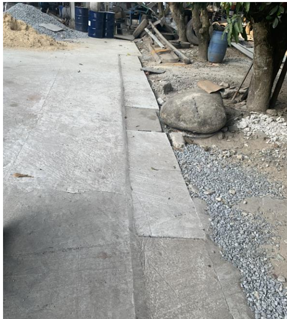
Hình 3.1: Mương dẫn nước mưa tại Nhà máy
