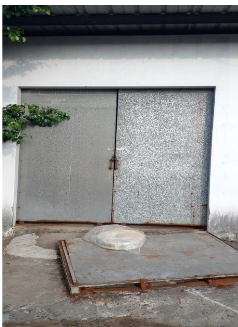
Hình 3.14: Kho chứa chất thải rắn công nghiệp thông thường
