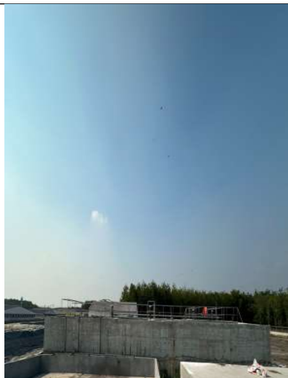
Hệ thống xử lý nước thải
