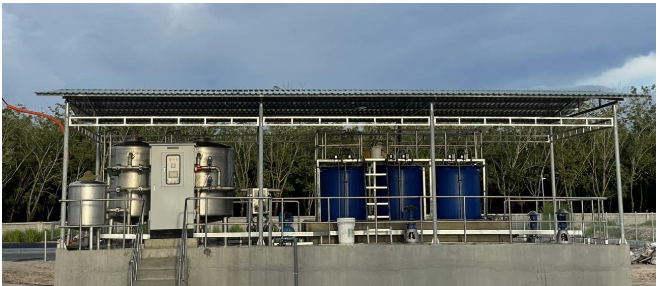
Hình 3. 6 Hệ thống xử lý nước sạch của Dự án
