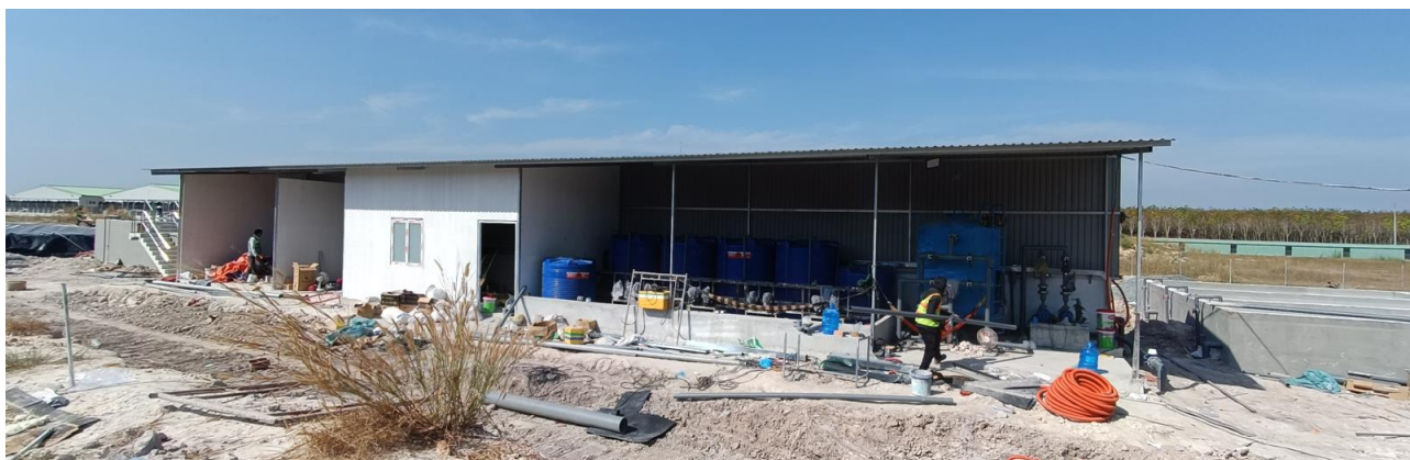
Hình 3. 4 Hình ảnh hệ thống xử lý nước thải của Dự án
