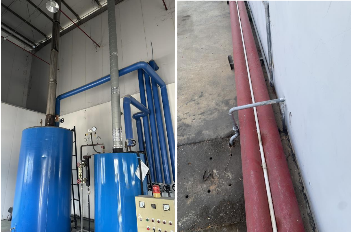
Hình 3.3: Lò hơi và đường ống xả đáy
