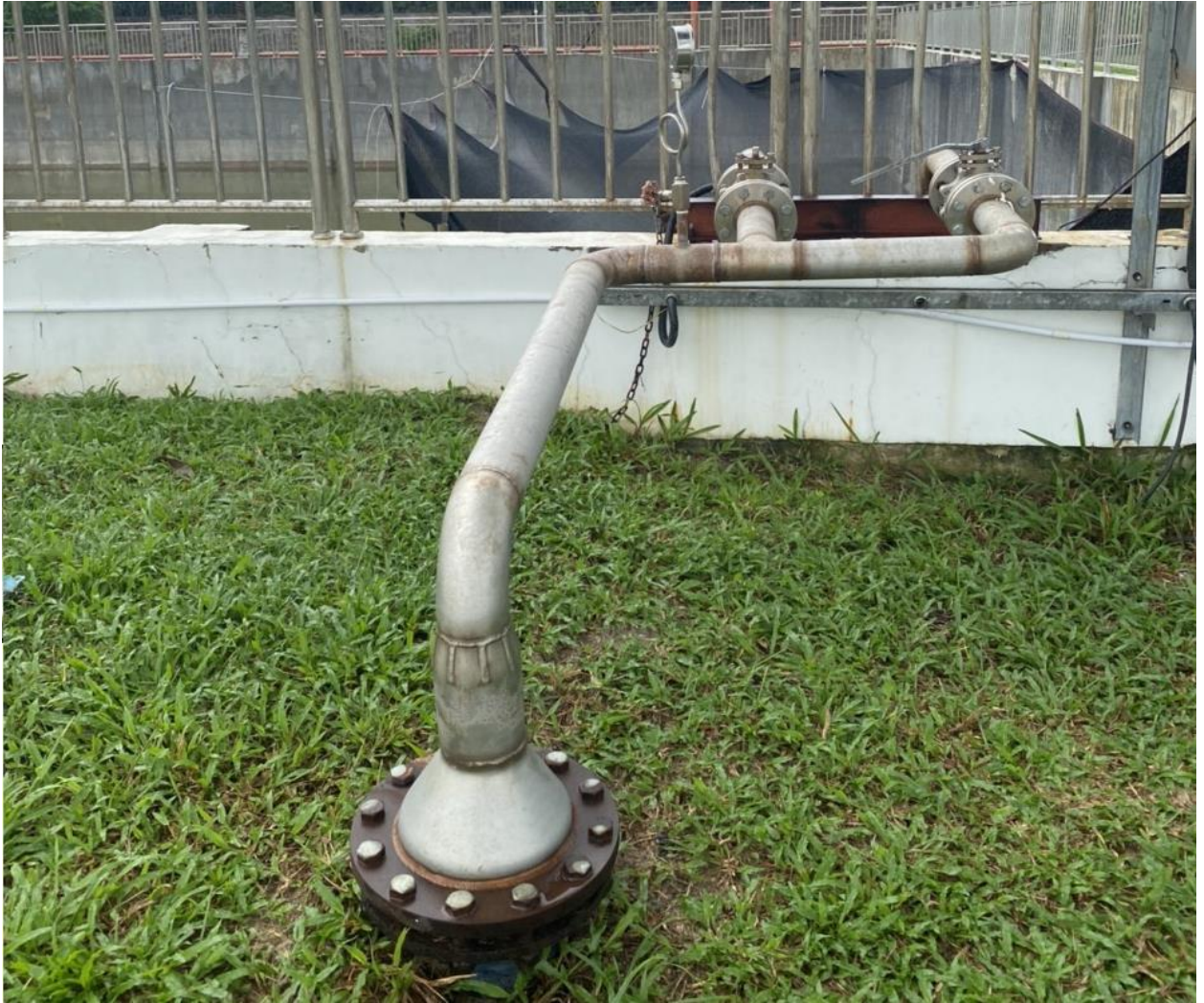
Hình 3. 7: Điểm đầu nối nước thải của dự án với KCN Phước Đông
