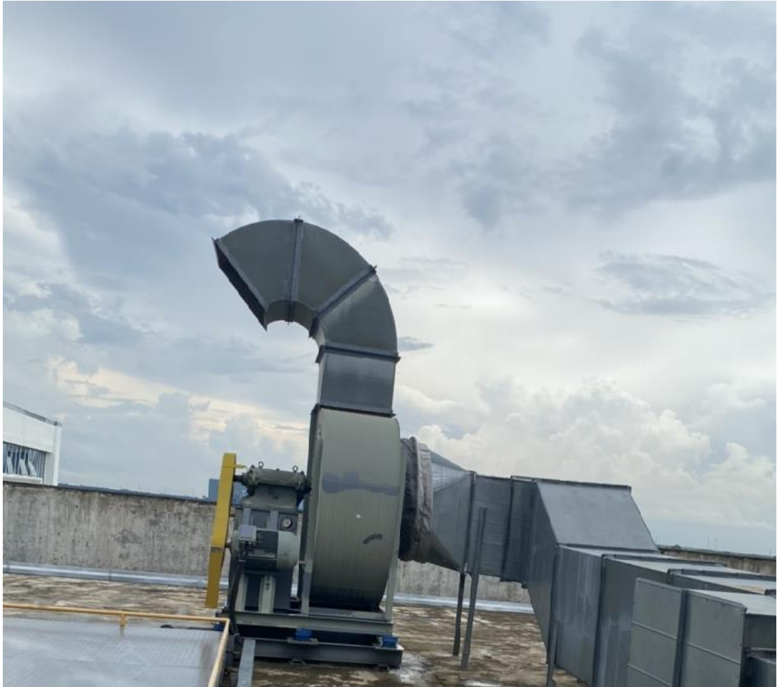
Hình 4. 3: Ống khói thải của thiết bị khử dầu tĩnh điện xử lý hơi dầu công suất 25.000m 3 /giờ/máy
