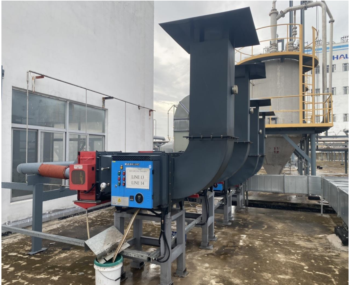
Hình 4. 1: Thiết bị khử dầu tĩnh điện xử lý hơi dầu công suất 3.000m 3 /giờ/máy
