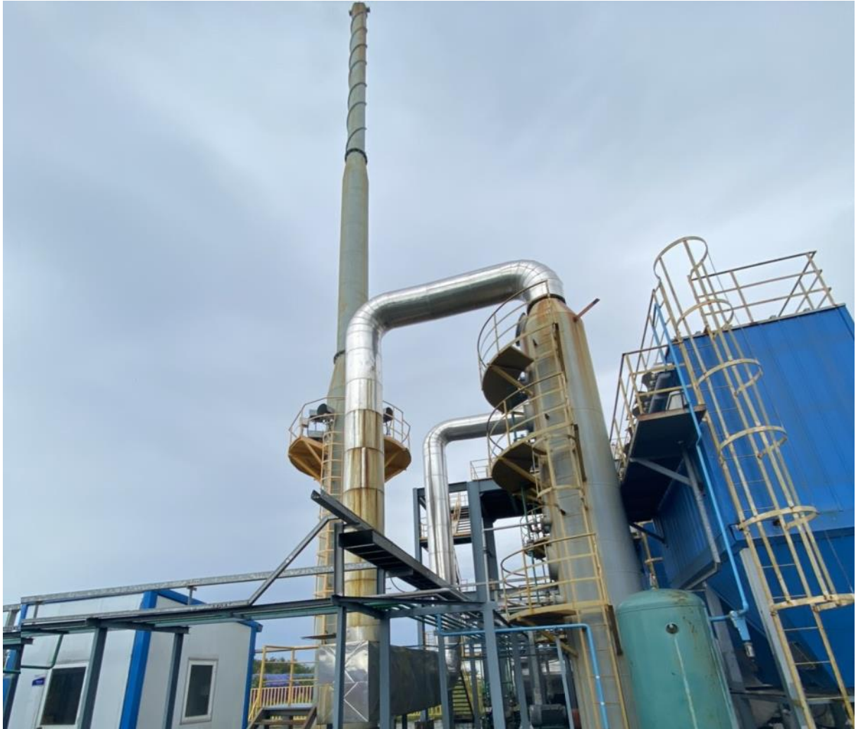
Hình 3. 11: Hệ thống xử lý khí thải lò dầu truyền nhiệt bằng than đá
