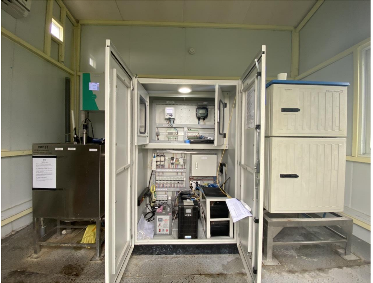
Hình 3. 6: Thiết bị quan trắc nước thải liên tục, tự động của dự án
