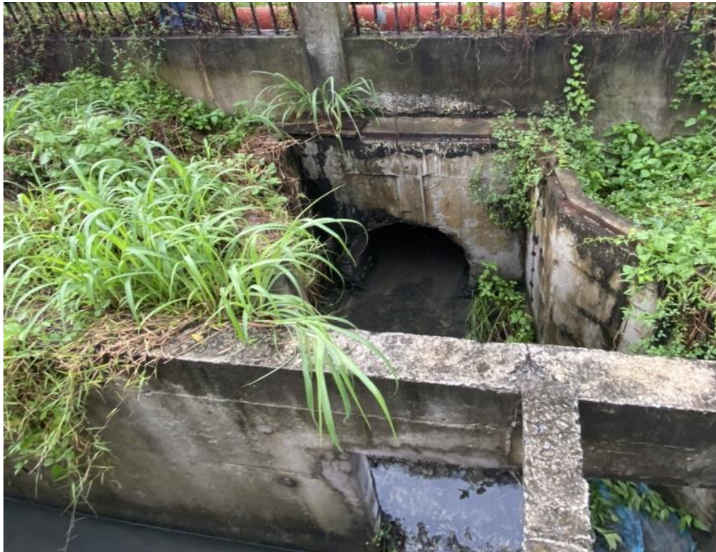
Hình 3. 2: Đường công tròn thoát nước mưa qua mương thoát nước mưa của KCN
