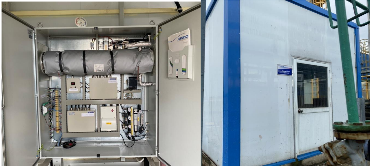
Hình 3. 10: Trạm quan trắc tự động, liên tục khí thải lò hơi
