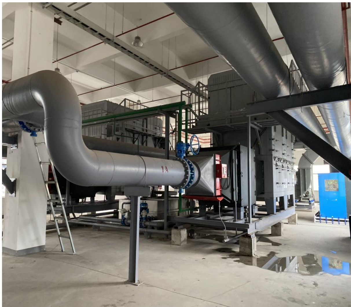
Hình 4. 2: Thiết bị khử dầu tĩnh điện xử lý hơi dầu công suất 25.000m 3 /giờ/máy
