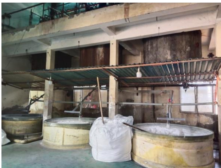
Hình 1.14 Ba bồn chứa tẩy rửa và lọc
