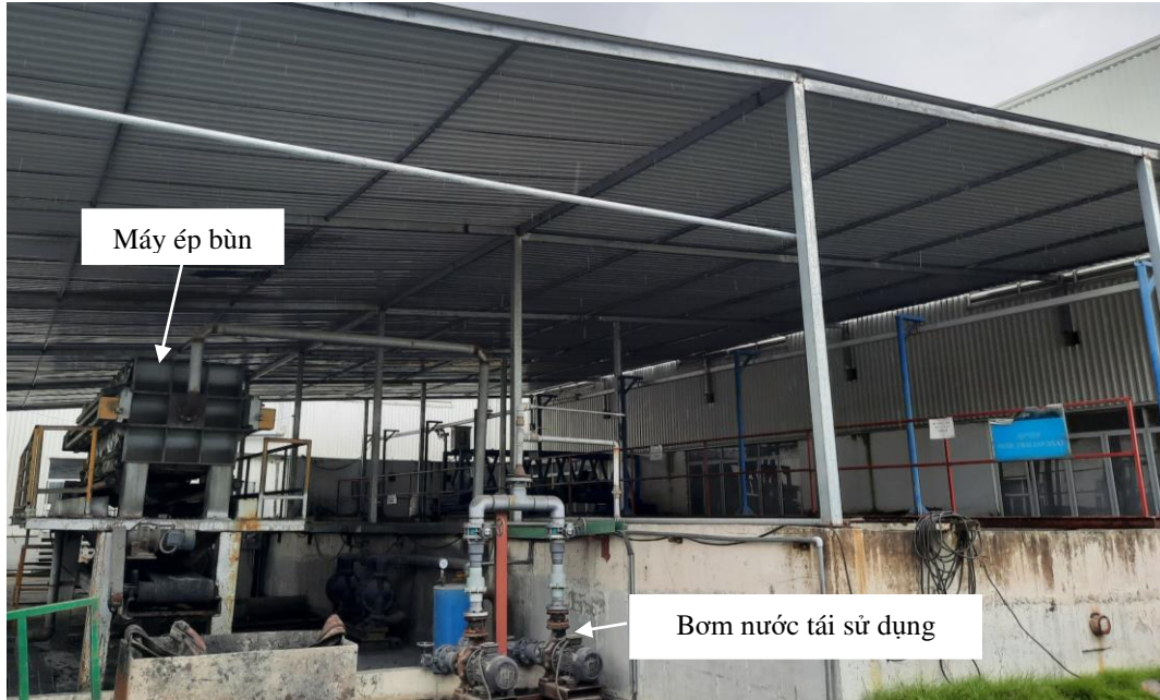
Hình 3. 7: Hệ thống xử lý nước thải sản xuất
