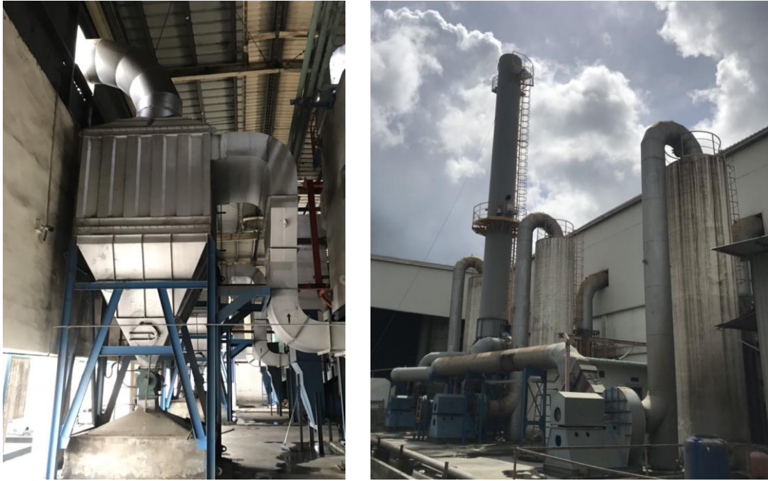
Hình 3. 17: Hệ thống xử lý khí thải lò hơi
