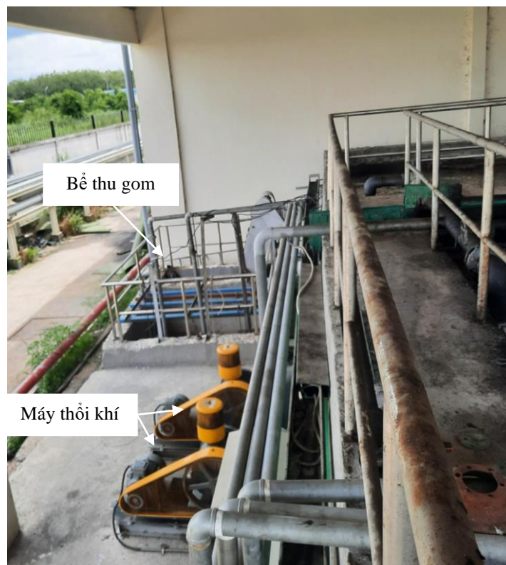
Hình 3. 5: Hệ thống xử lý nước thải sinh hoạt
