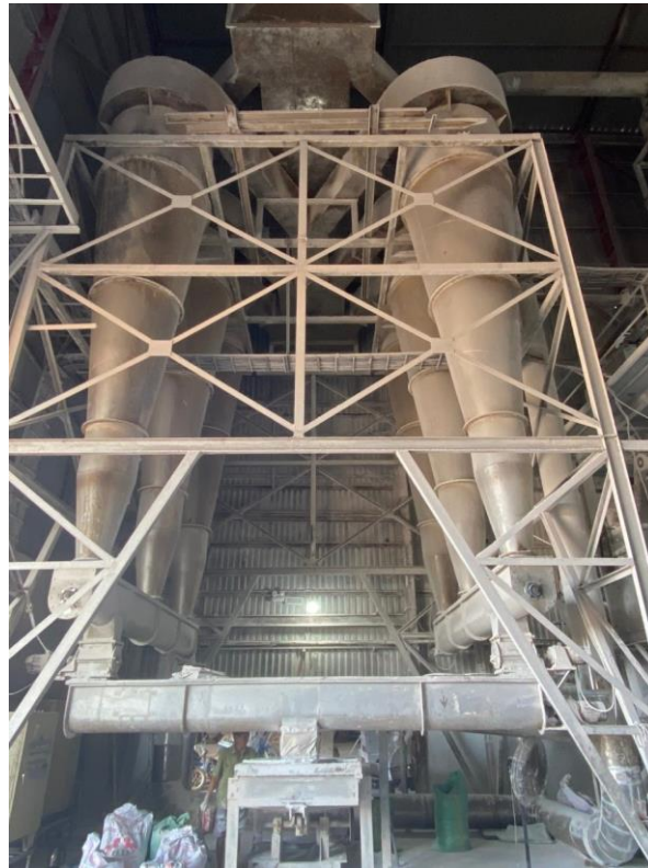
Hình 3.15: Bộ cyclone xử lý bụi từ lò sấy tinh bột
