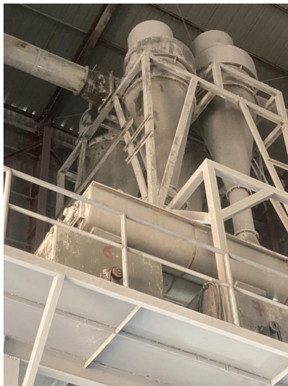
Hình 3.17: Bộ cyclone xử lý bụi từ công đoạn đóng bao
