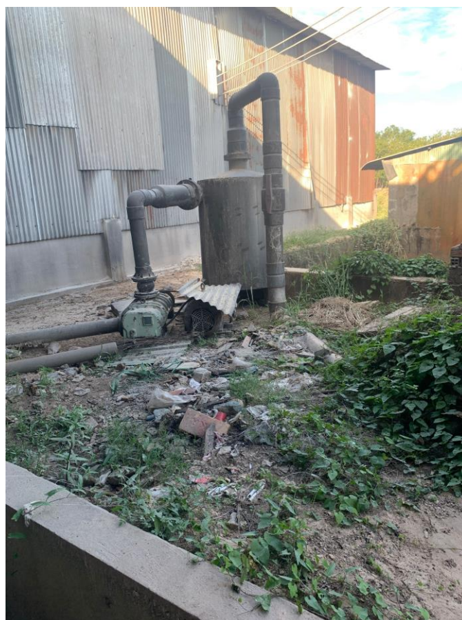
Hình 3.9: Bồn tách ẩm khí biogas
