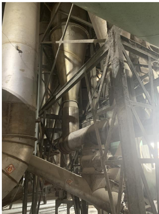
Hình 3.16: Bộ cyclone xử lý bụi từ lò sấy bã mì
