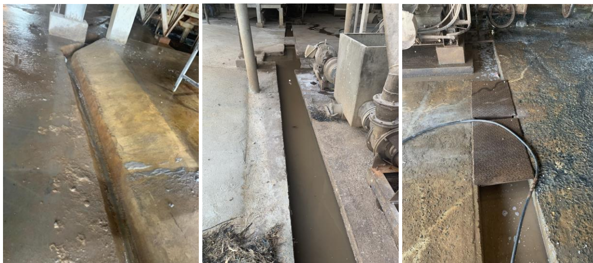
Hình 3.5: Mương thu gom nước thải bên trong Nhà máy
