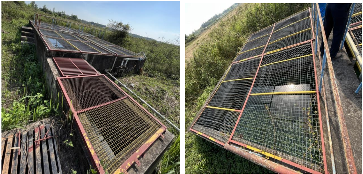
Hình 5. Hình ảnh HTXLNT tập trung của dự án
