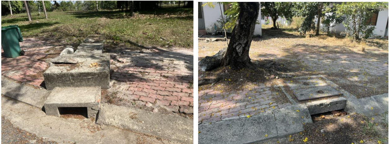
Hình 2. Hình ảnh hố ga thu gom thoát nước mưa của dự án
