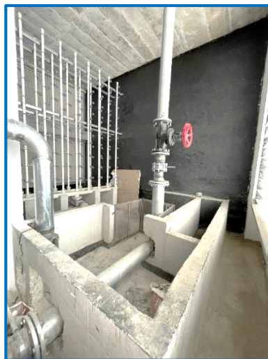
Bể nước làm mà và giàn phun sương
