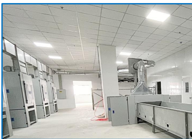
Đường ống thu gom bụi
