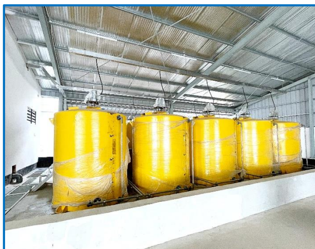
Khu hóa chất xử lý nước thải
