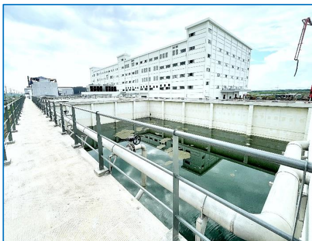
Bể điều hòa
