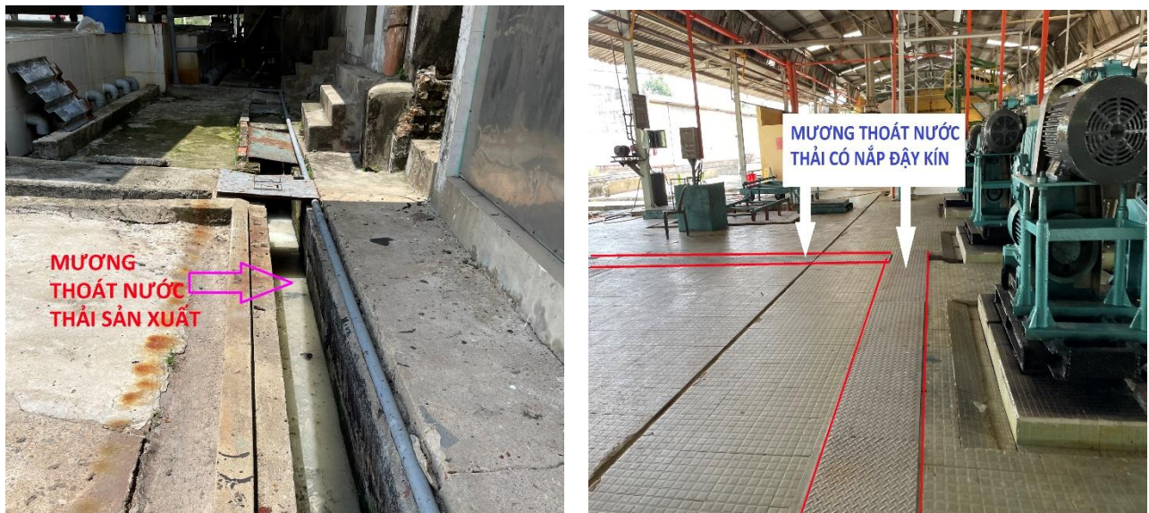
Hình 3. 4: Đường thoát nước thải sản xuất tại Nhà máy
