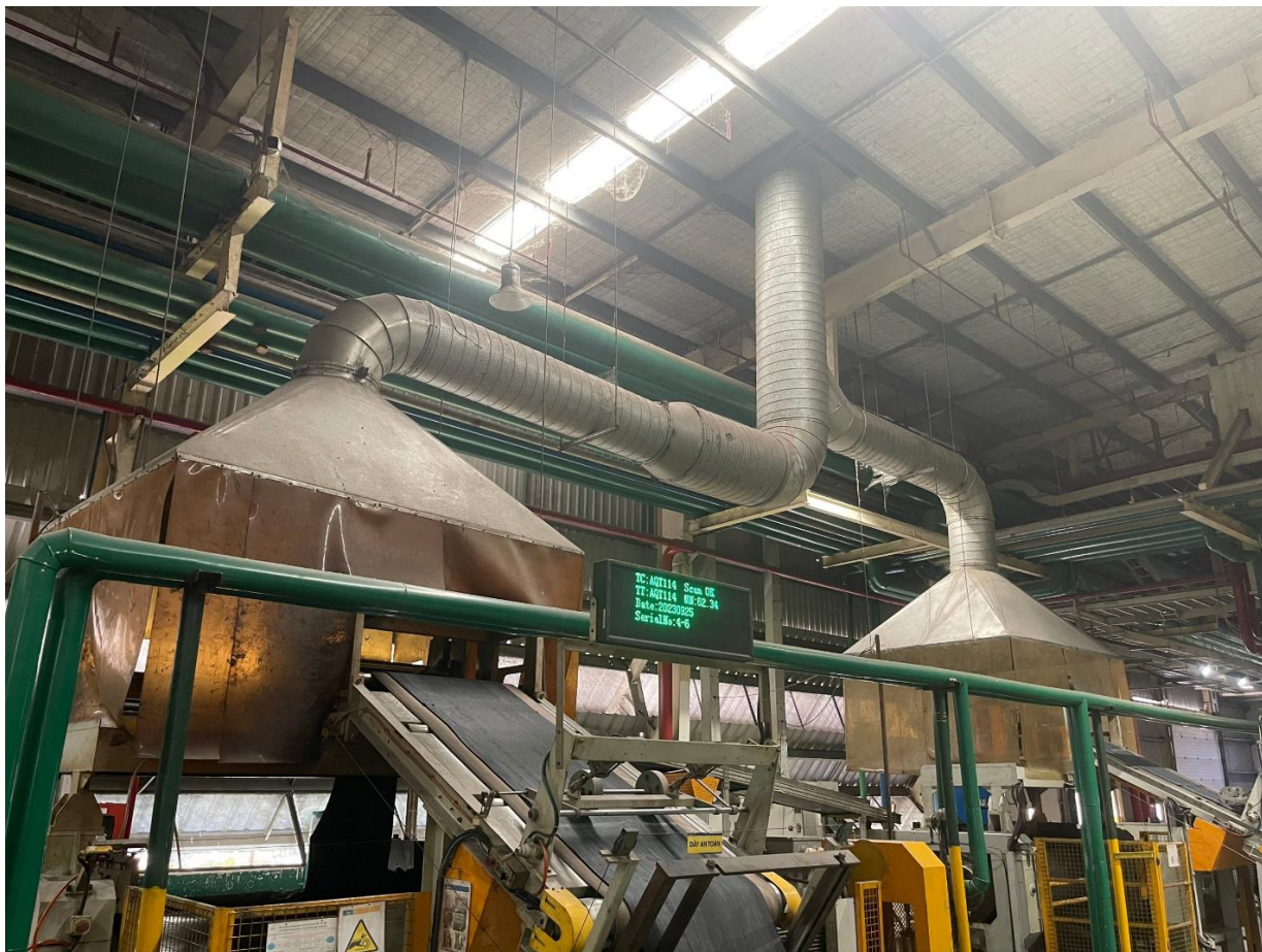
Hình 3.14 Hình ảnh hệ thống thoát nhiệt thừa khu vực ép đùn
