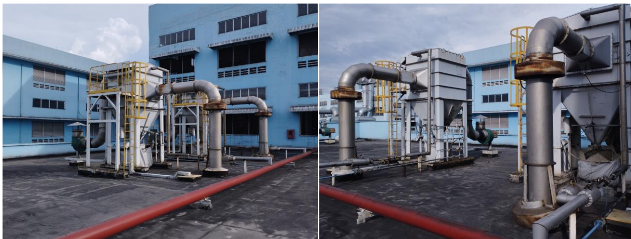
Hình 3.10 Hình ảnh hệ thống xử lý khí thải của máy phối liệu
