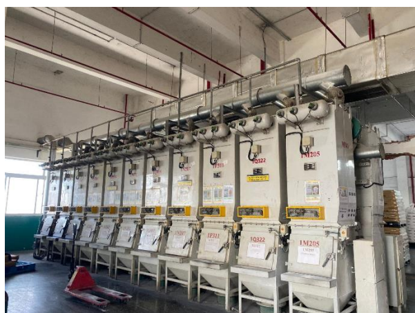
a) Hệ thống xử lý bụi máy cân M301
