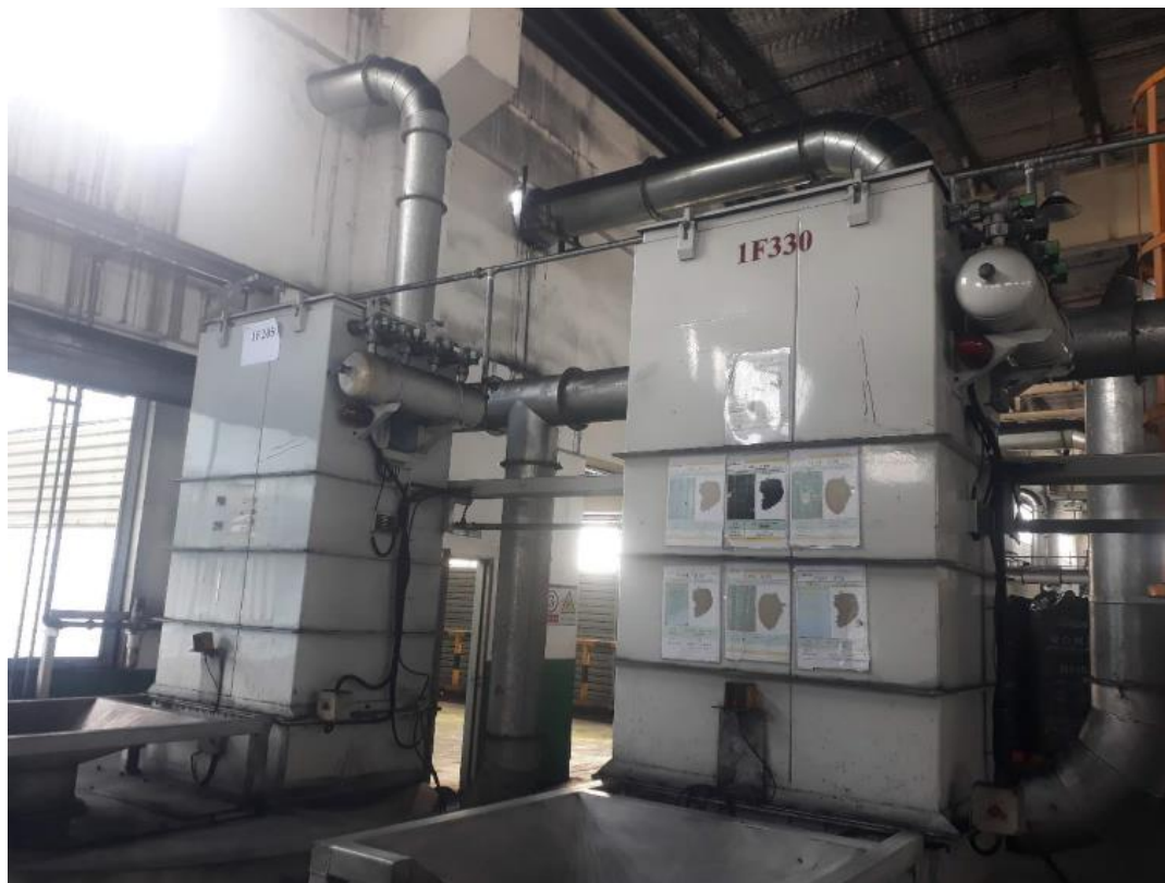
Hình 3.6 Hệ thống xử lý bụi từ máy nạp nguyên liệu than đen
