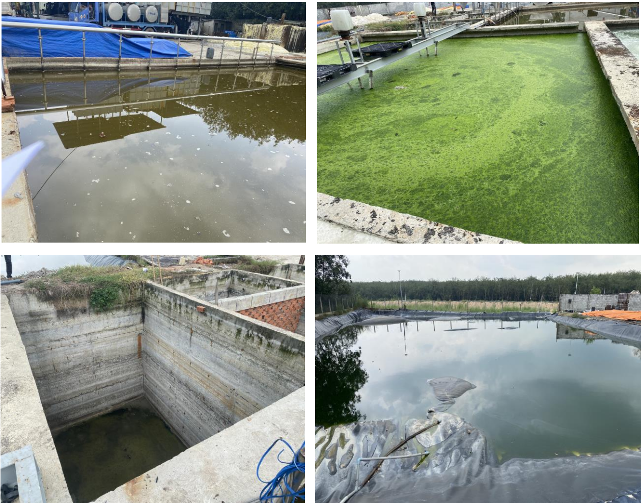
Hình 3.2. Các bể trong hệ thống xử lý nước thải tại nhà máy
