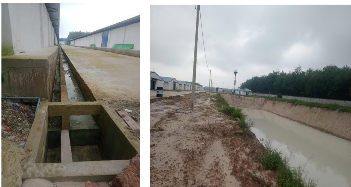
Hình 3.2 Đường thoát nước mưa và ao thu nước mưa
