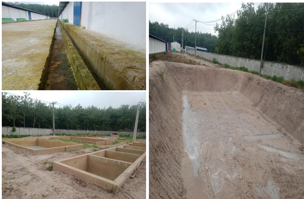
Hình 3.7: Hình ảnh hệ thống xử lý nước thải
