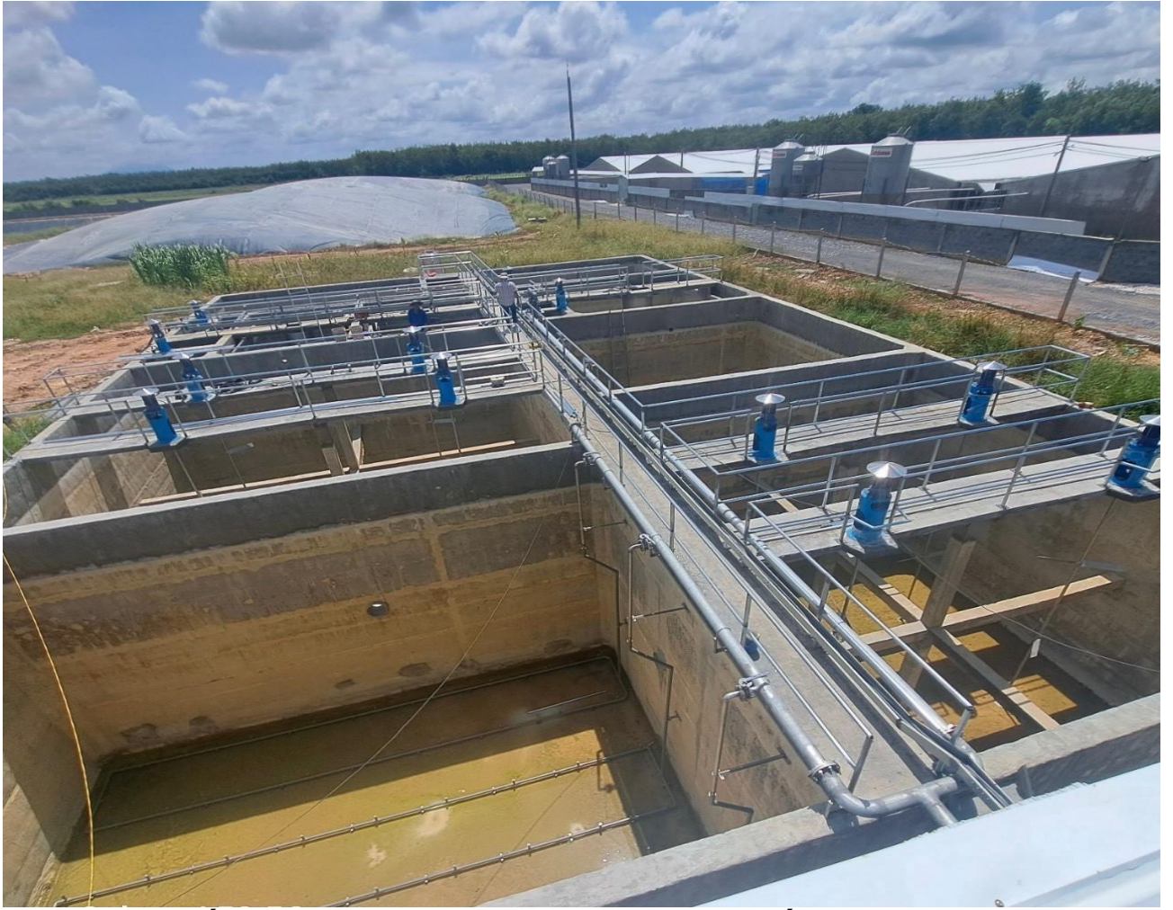
Hệ thống xử lý nước thải tập trung có công suất 400m 3 /ngày
