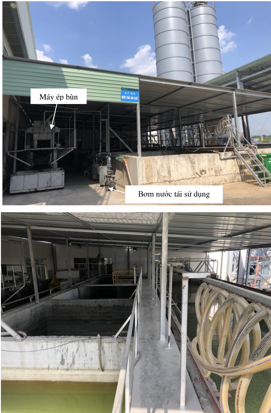
Hình 3. 7: Hệ thống xử lý nước thải số 02, công suất 100m 3 /ngày
