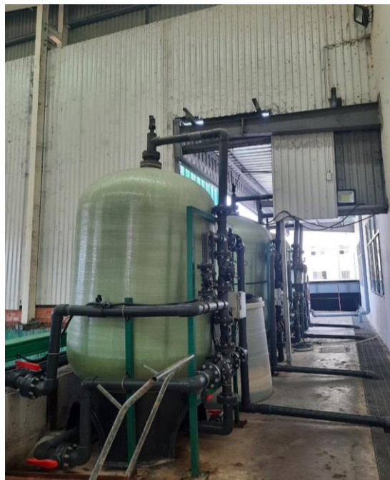
Hình 3. 9: Hệ thống xử lý số 03, công suất 300\text{m}^3/\text{ngày}
