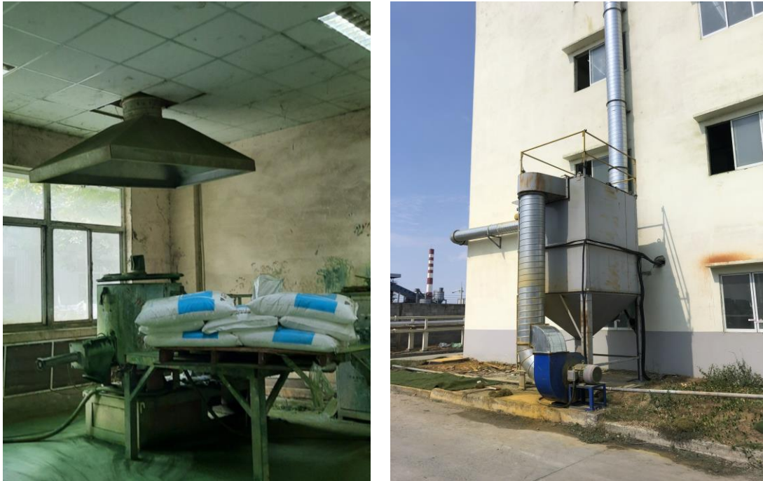
Hình 3. 16: Hệ thống xử lý bụi tại công đoạn pha bột màu
