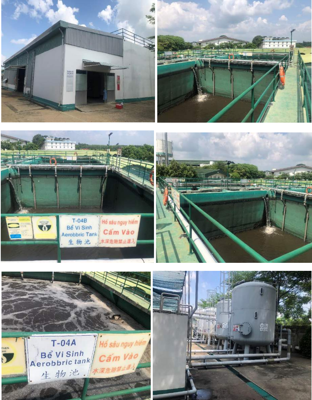
Hình 3. 9 - Hình ảnh công trình HTXL nước thải tập trung của Công ty
