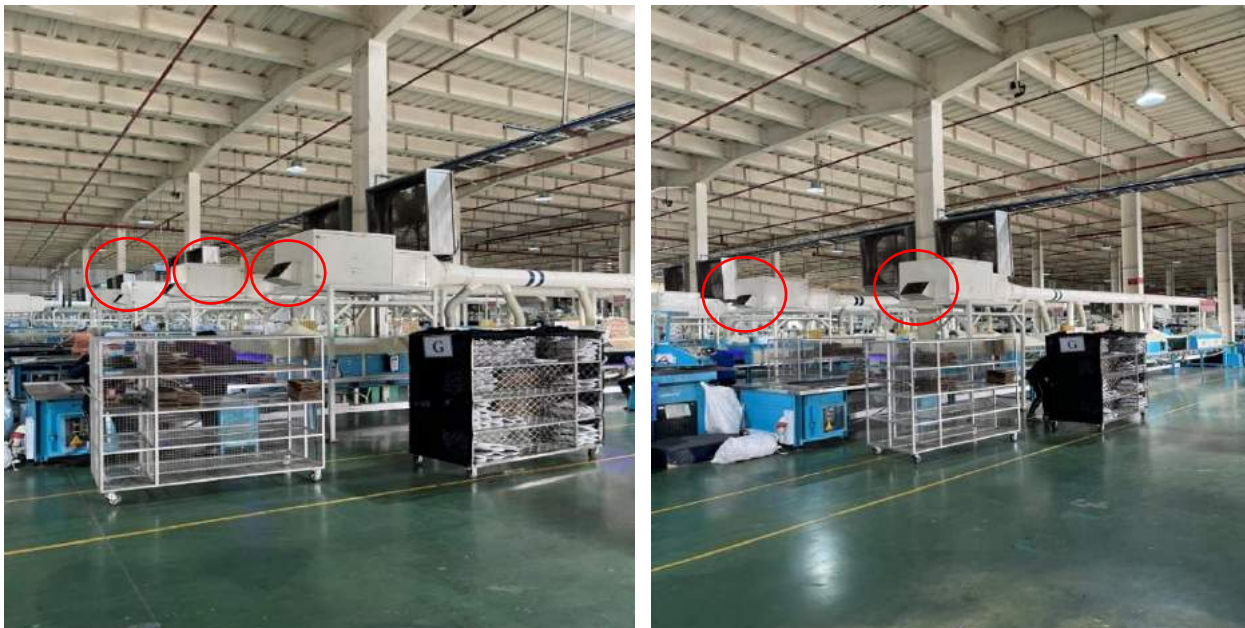
Hình 3. 12 - Hình ảnh của 54 công trình HTXL hơi hóa chất đi kèm thiết bị trong các xưởng sản xuất
