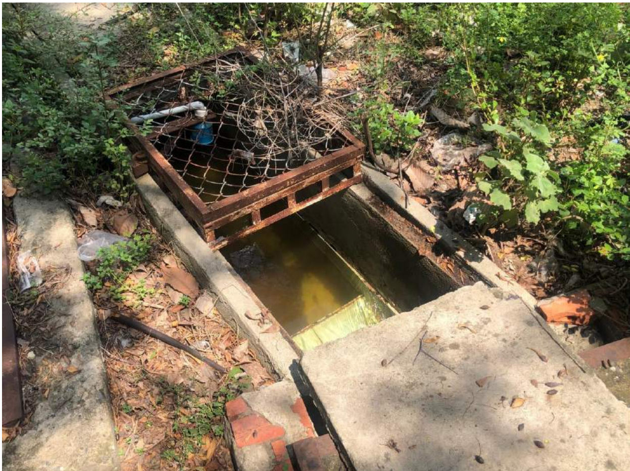
Hình 3.4 - Hình ảnh hố ga đầu nối nước thải với KCN Chà Là
