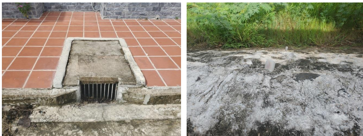
Hình 3. 3. Hồ ga thu gom và đường ống thoát nước mưa
