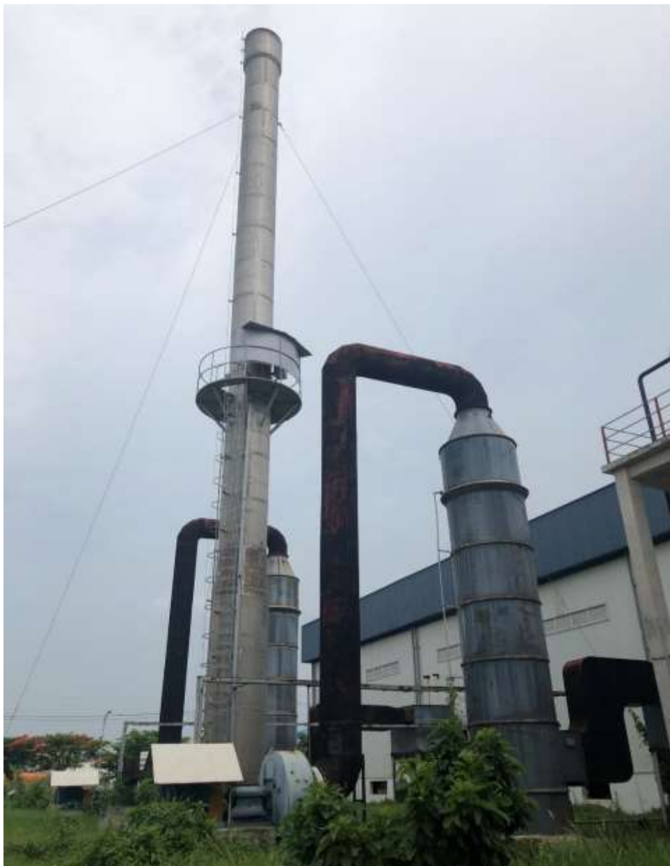
Hình 3. 10 – Hình ảnh công trình ống thoát khí thải chung lắp đặt hệ thống quan trắc tự động, liên tục của lò hơi và lò dầu
