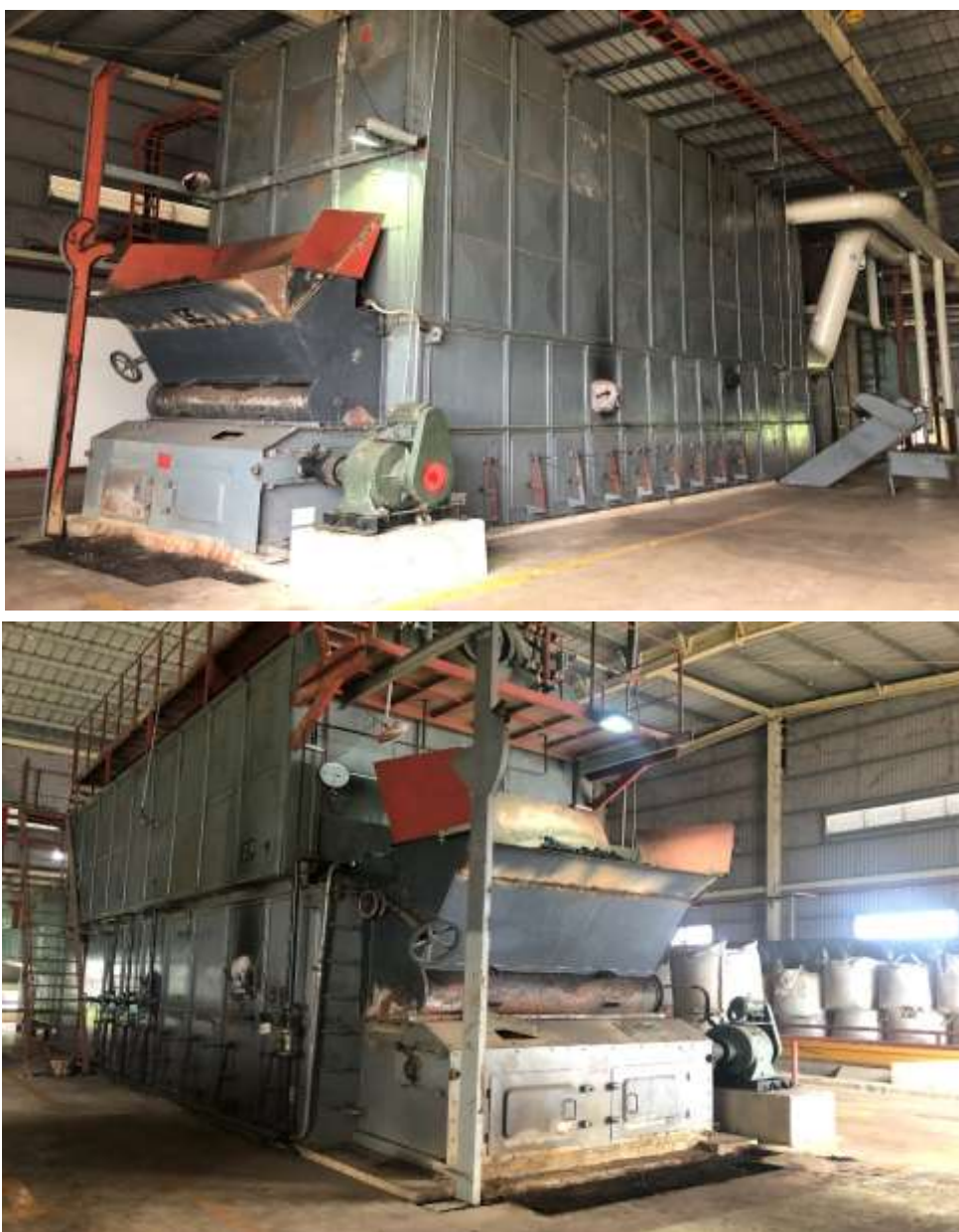
Hình 3. 9 – Hình ảnh lò hơi và lò dầu tải nhiệt của Dự án
