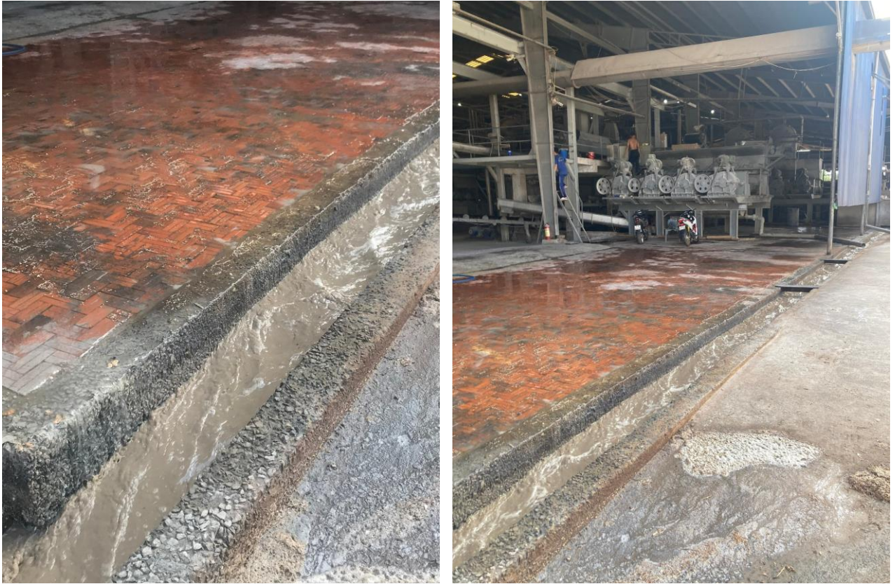
Hình 3.3. Hình ảnh hệ thống thoát nước thải của Nhà máy
