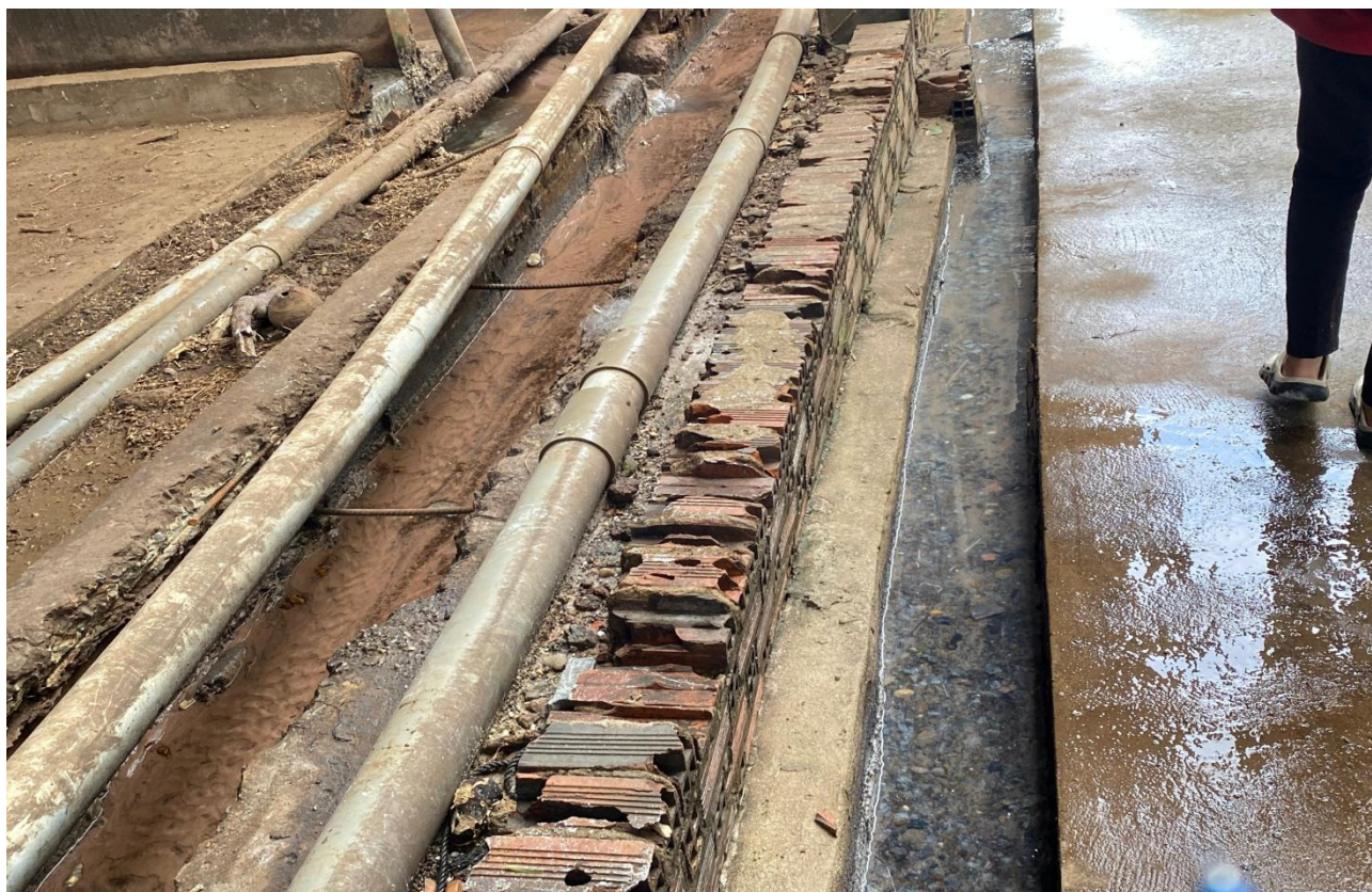
Hình 3.5. Mương thu gom nước thải
