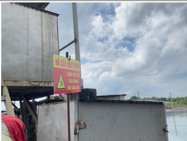
Bể keo tụ - tạo bông
