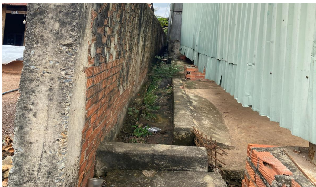
Hình 3.1. Mương thu gom, thoát nước mưa.
