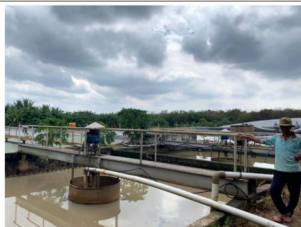
Bể lắng hoá lý - Bể lắng sinh học
