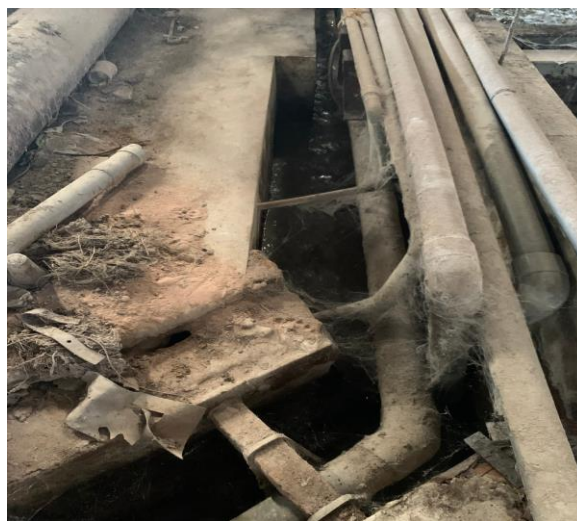
Hình 3.3: Mương thu gom nước thải chế biến tinh bột mì
