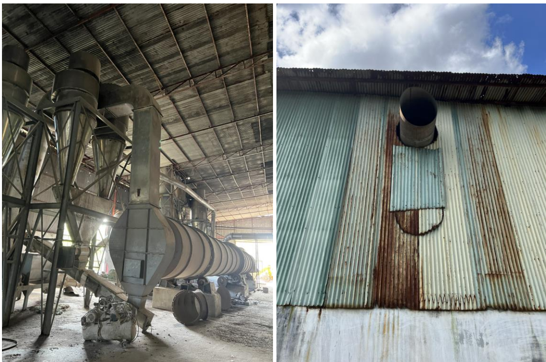
Hình 3.9: Xử lý bụi từ lò sấy bã mì
