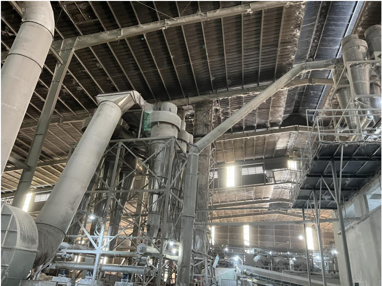
Hình 3.8: Xử lý bụi từ lò sấy tinh bột
