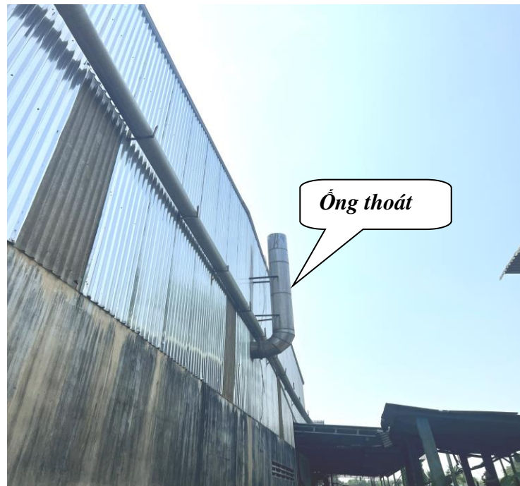
Ống thoát khí thải của lò sấy số 1
