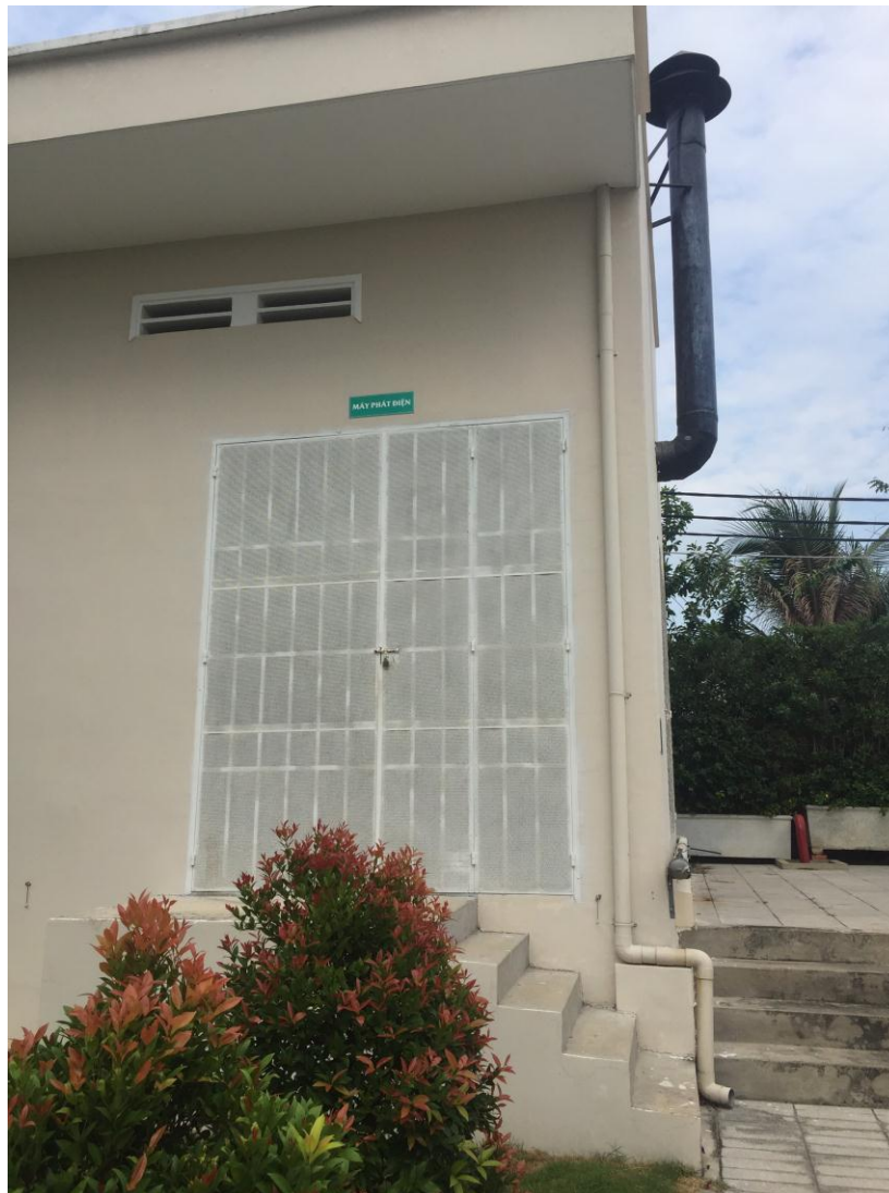
Hình 3.6: Máy phát điện công suất 750 KVA
