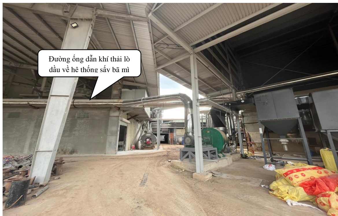
Hình 3.9. Đường ống thu hồi khí thải lò dầu để cấp nhiệt cho hệ thống sấy bã
