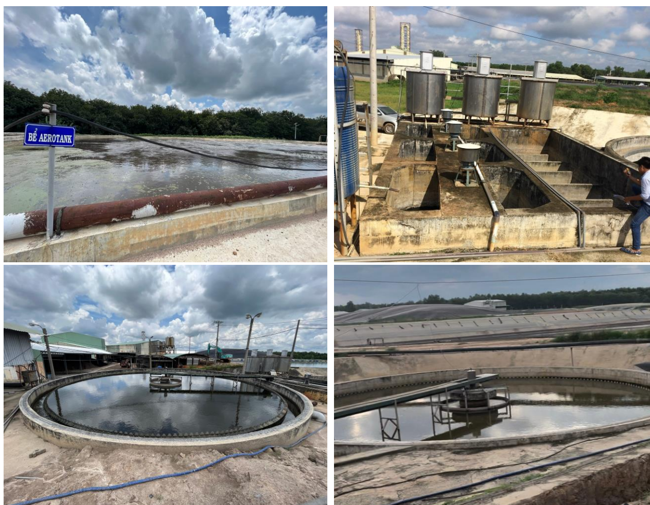
Hình 3.6. Các hạng mục xử lý nước thải
