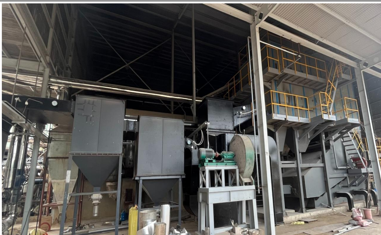
Hình 3.8. Hình ảnh cyclone xử lý khí thải đã lắp đặt tại nhà máy
