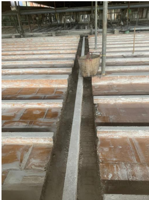
Hình 3.4: Mương thu gom nước thải
