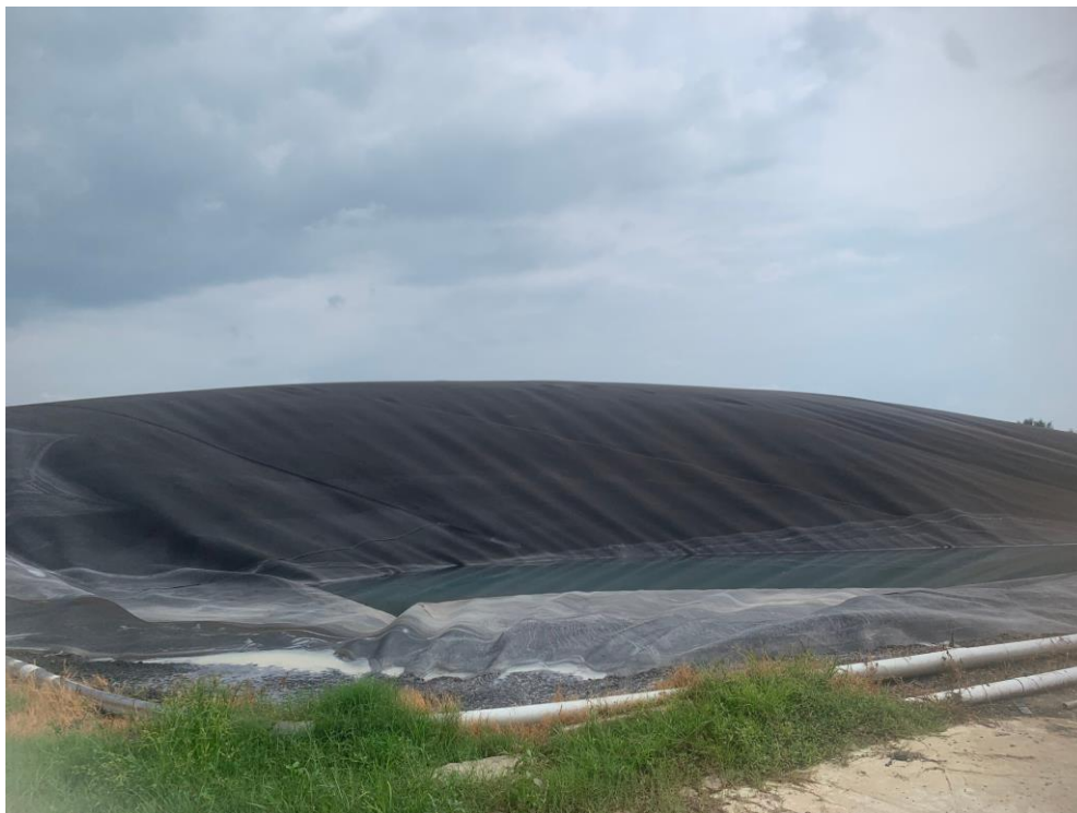
Hình 3.10: Bể biogas tại Nhà máy
