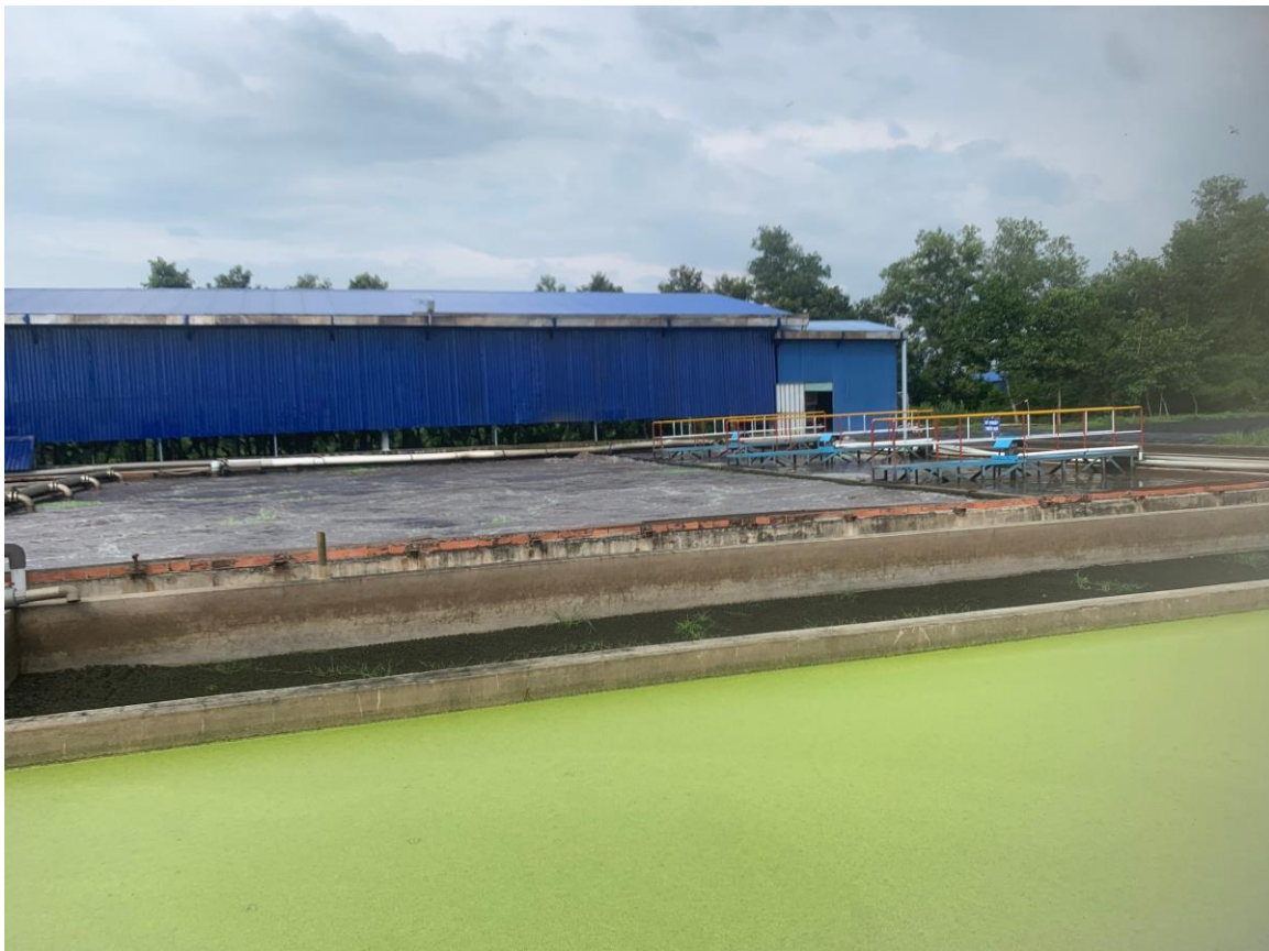
Hình 3.11: Hệ thống xử lý nước thải
