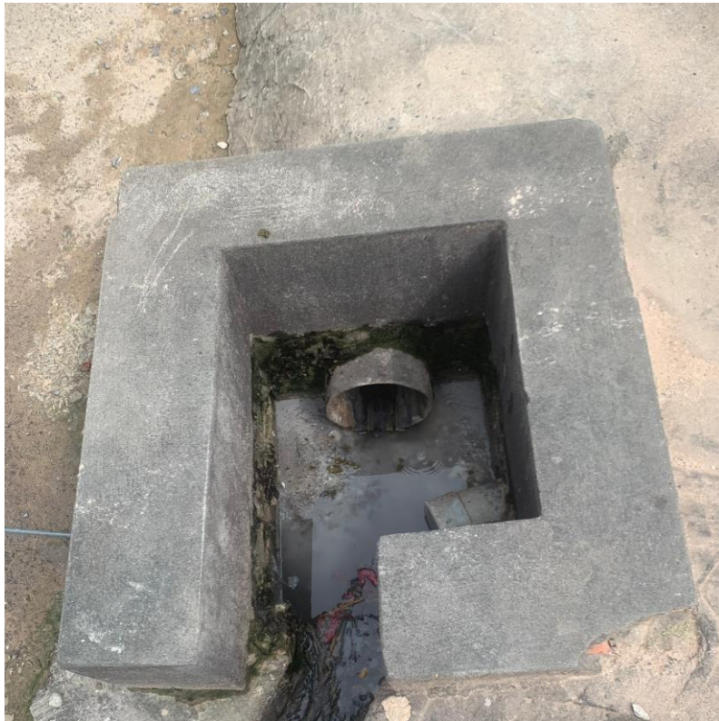
Hình 3.2: Hố ga thu gom nước mưa chảy qua khu vực chứa bã mì tươi
