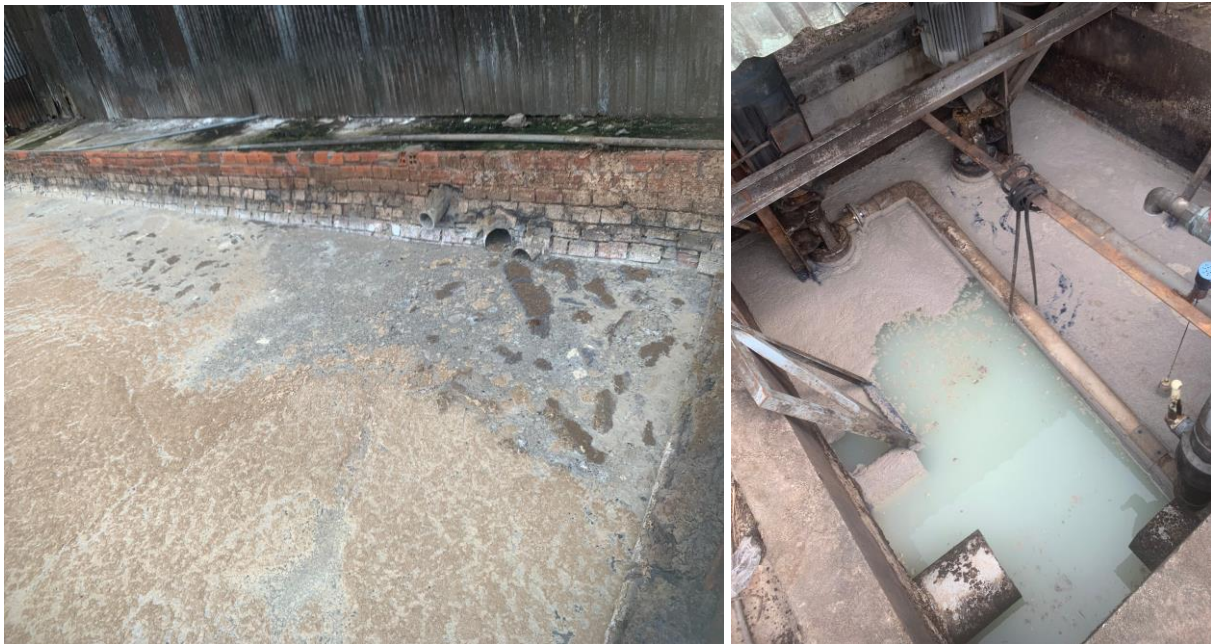
Hình 3.6: Cụm bể lắng mù và bơm nước thải
