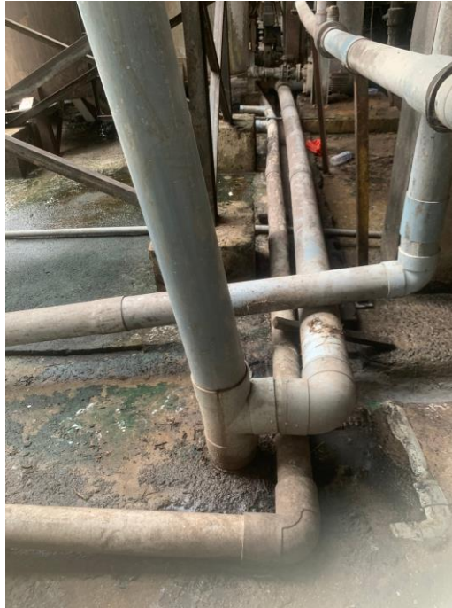
Hình 3.5: Đường ống thu gom nước thải từ công đoạn băm, mài, ly tâm.
